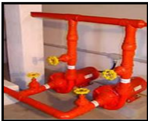
Figura 14 - Bomba de Incêndio
