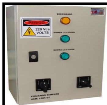
Figura 18 – Quadro de comando
