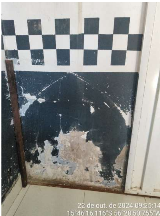
Figura 13: Paredes com umidade.
