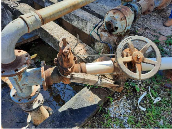
FOTOS 09, 10, 11 E 12: INSTALAÇÕES HIDRÁULICAS DA ESTAÇÃO DE TRATAMENTO DE ÁGUA.
