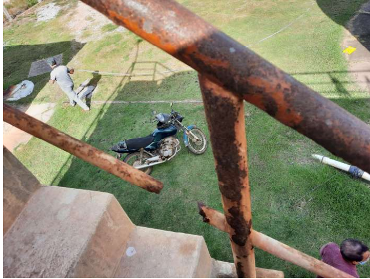
FOTOS 05, 06, 07 E 08: ESTRUTURA DA ESTAÇÃO DE TRATAMENTO DE ÁGUA, DEMOSTRANDO DESGASTES E PROBLEMAS NA ESTRUTURA PELA FALTA DE MANUTENÇÃO E CUIDADO.
