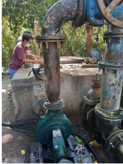
FOTOS 13, 14, 15, 16 E 17: INSTALAÇÕES DA CAPTAÇÃO DE ÁGUA BRUTA, MOSTRANDO PROBLEMAS ESTRUTURAIS E DE CORROSÃO.
