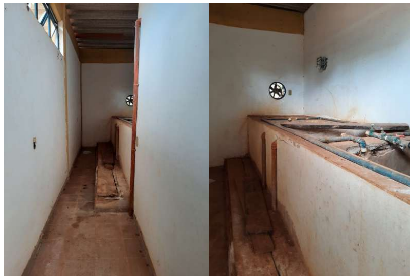
FOTOS 03, 04: INSTAÇÕES DA CASA DE QUIMICA EM MÁS CONDIÇÕES DE OPERAÇÃO.
