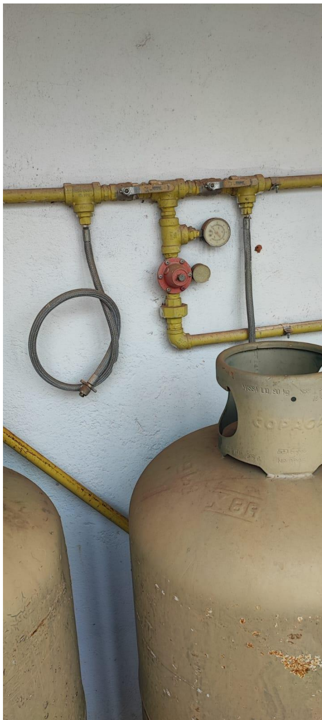
Figura 32 – Conexões de Gás GLP - Existente (imagem própria)
