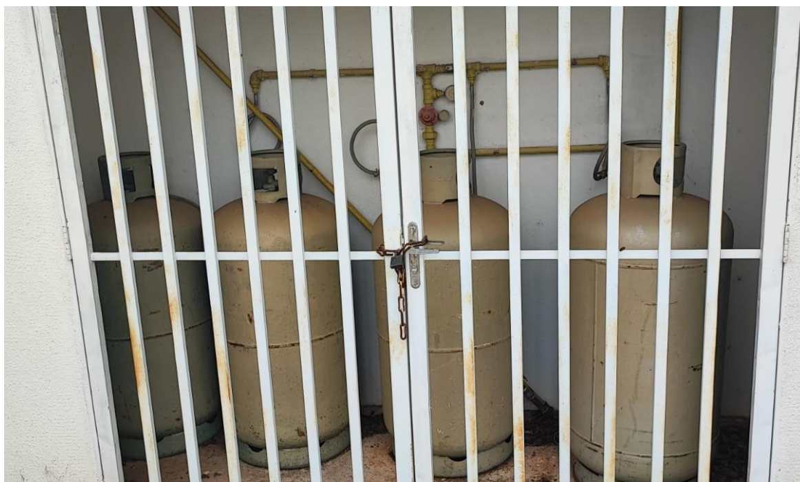
Figura 31 – Central de Gás GLP do Restaurante - existente (imagem própria)
