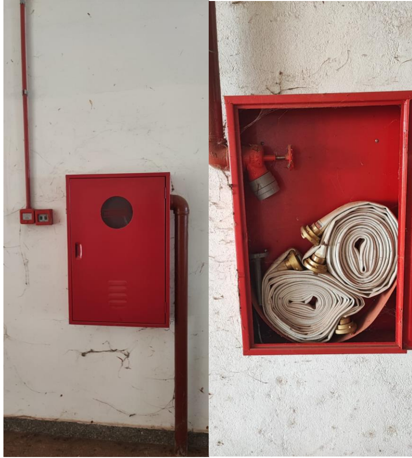
Figura 21 – Hidrante Existente (imagem própria) Figura 21.1 – Hidrante Existente (imagem própria)
