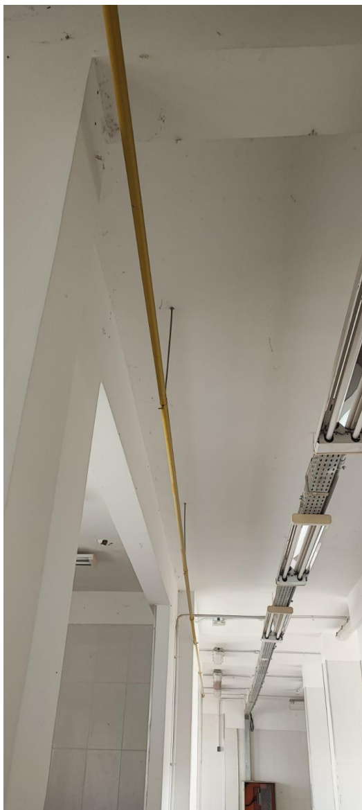
Figura 33 – Tubulação amarela de gás GLP - Existente (imagem própria)
