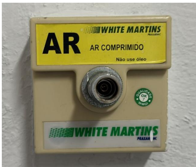
Figura 30 – Ponto para ar comprimido (imagem própria)
