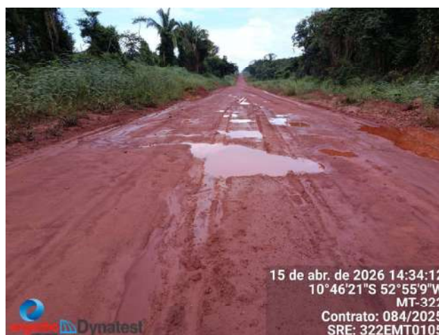
FOTO 18 – PANEIS E ACÚMULO DE ÁGUA NA PISTA
