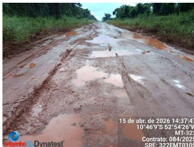
FOTO 17 - PANEIS E ACÚMULO DE ÁGUA NA PISTA
