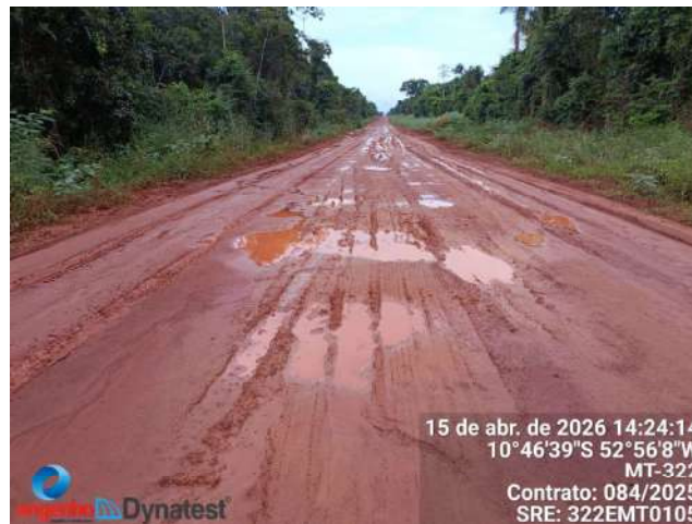
FOTO 14 – PANELAS E ACÚMULO DE ÁGUA NA PISTA
