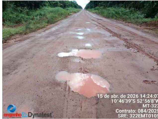
FOTO 13 - PANELAS E ACÚMULO DE ÁGUA NA PISTA
