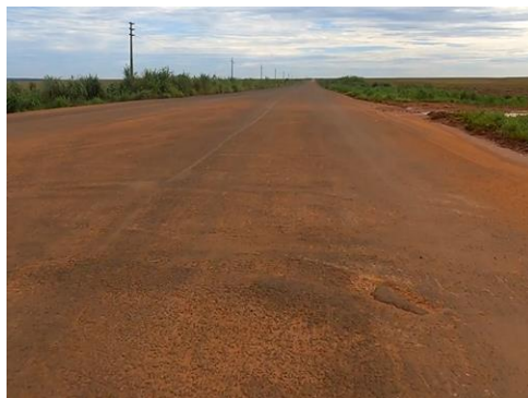
Figura 5-9 – Trecho da MT-249 objeto do Projeto de Restauração com presença de irregularidades no leito estradal
