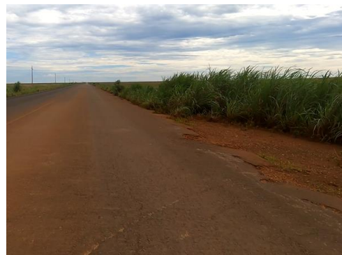
Figura 5-10 – Trecho da MT-249 objeto do Projeto de Restauração – acostamento com pontos de ausência de pavimento e fissuras na pista central
