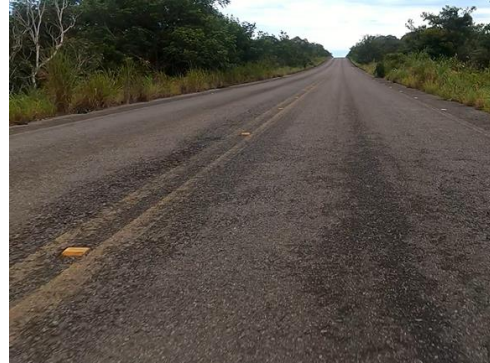
Figura 5-12 – Trecho da MT-249 objeto do Projeto de Restauração – fissuras na pista
