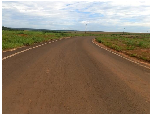
Figura 5-7 – Trecho da MT-249 objeto do Projeto de Restauração com presença de fissuras no pavimento
