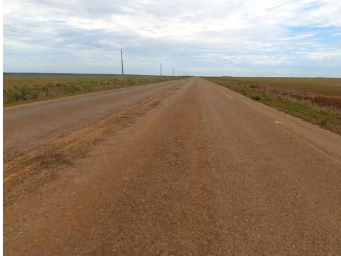
Figura 5-11 – Trecho da MT-249 objeto do Projeto de Restauração – fissuras na pista
