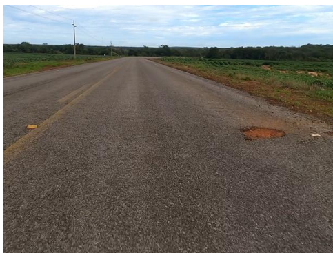
Figura 5-15 – Trecho da MT-249 objeto do Projeto de Restauração – presença de buraco na pista e camada superficial se desintegrando
