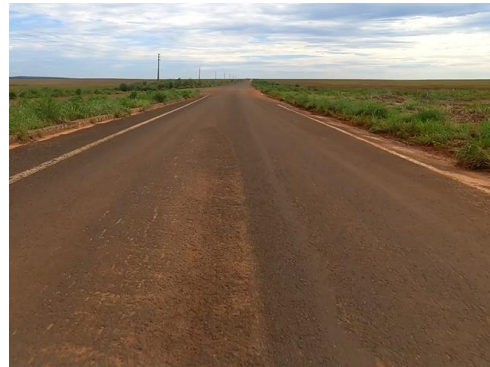
Figura 5-8 – Trecho da MT-249 objeto do Projeto de Restauração com presença de fissuras no pavimento
