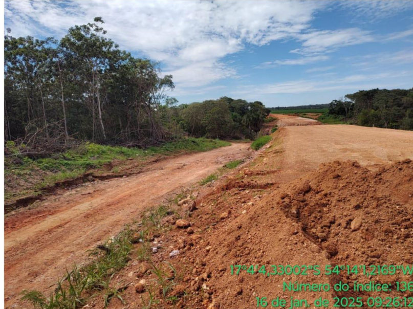
Figura 15 – Vista do local a ser implantada a ponte sobre o Ribeirão Ponte de Pedra
