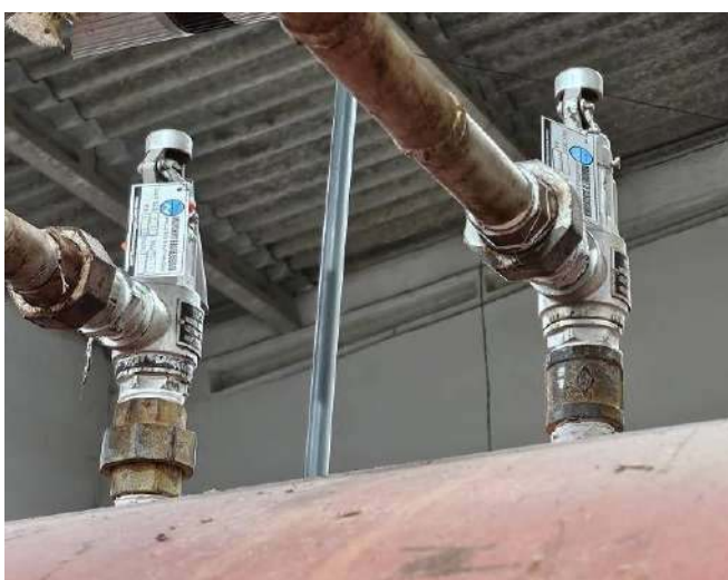
Fig. 4 Válvulas de Segurança.
