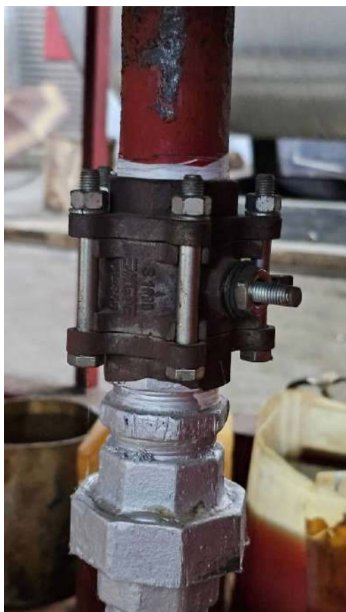
Fig. 12 Válvula 1 do Dreno.
