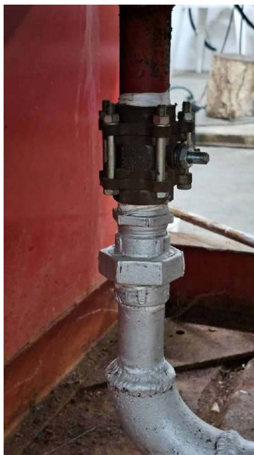
Fig. 13 Válvula 2 do Dreno.
