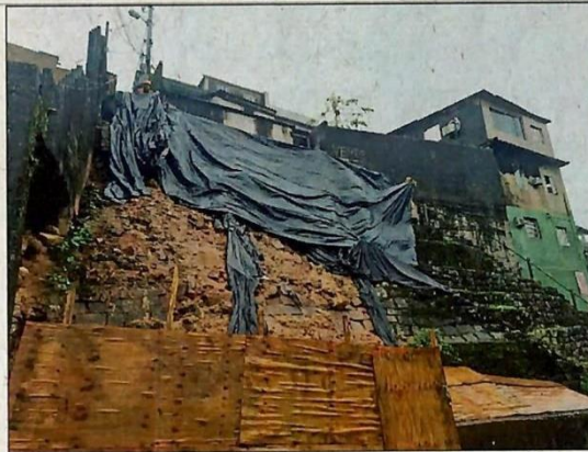
Figura 4 – Foto obtida em 01/07/2025 mostra colocação de nova lona no local de colapso do muro. Notar anteparo de madeira instalado no sopé do mesmo.
