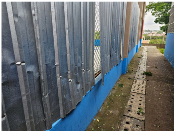
Figura 4: Chapas de zinco amassadas pela força do vento
