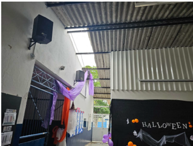
Figura 3: Telhas de fibrocimento arrancadas pela força do vento
