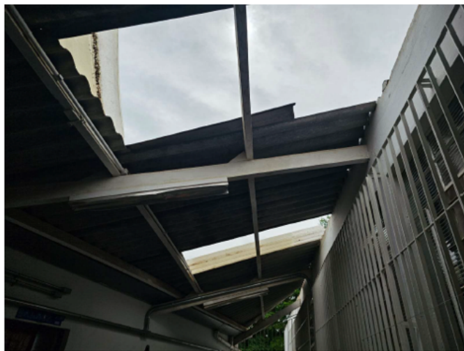
Figura 2: Telhas de fibrocimento arrancadas pela força do vento
