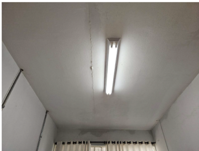
Figura 6: Laje úmida com goteiras.
