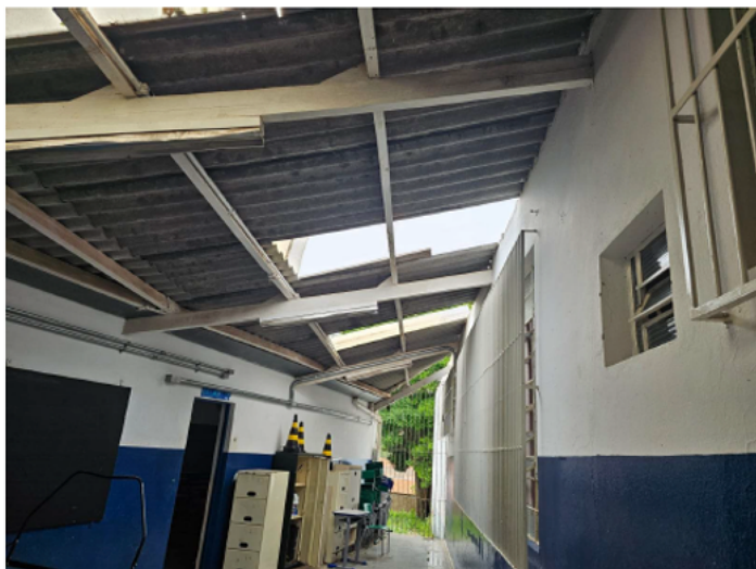
Figura 1: Telhas de fibrocimento arrancadas pela força do vento.
