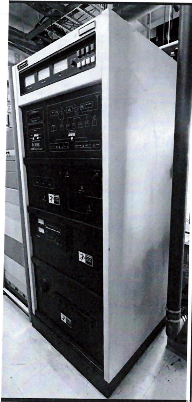
Gabinete do transmissor 300 kg LxAxP (0,85 x 1,83 x 0,85 metros) 1.5 Patrimônio
