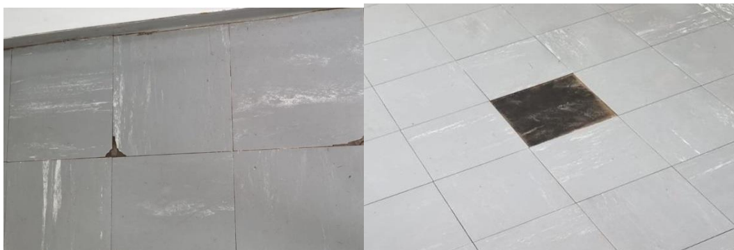
Figura 1 – Piso vinílico a ser substituído
