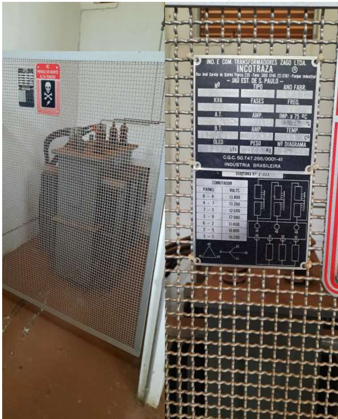
Transformador 1 - Potência 225KVA
