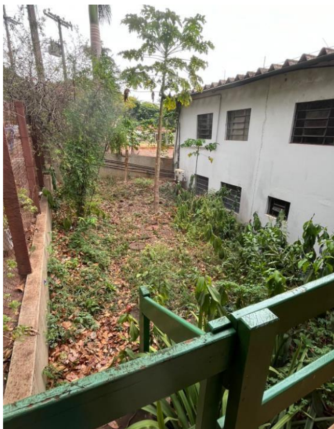
Figura 2 – Camada vegetal e de solo em contato com estrutura
