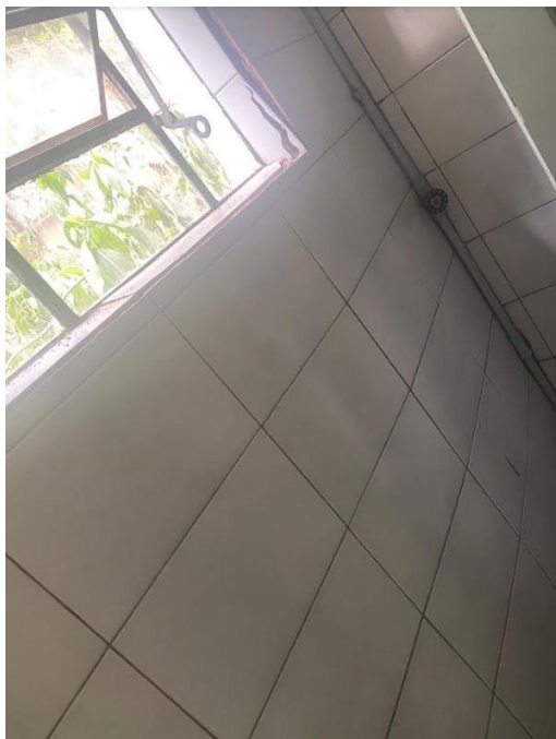
Figura 8 – Quebras no azulejo do banheiro 02
