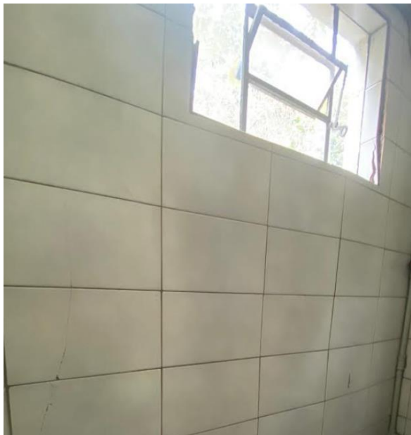
Figura 4 – Quebras e descolamentos dos azulejos devido à infiltração de água do solo
