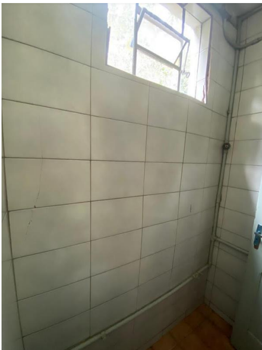
Figura 9 – Azulejos com trincas – Banheiro 02
