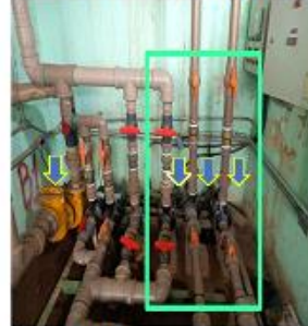
Visão da bomba jacuzzi reserva aguardando manutenção
