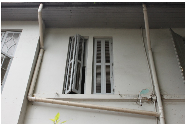
Detalhe de parte de uma ligação inadequada das prumadas de águas pluviais. Trata-se de uma intervenção que além de não solucionar diretamente o problema de escoamento afeta a harmonia do conjunto das fachadas.
