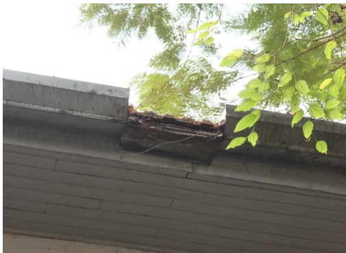
Detalhes das condições atuais das calhas.
