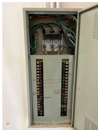
Figura 5 – Foto 4: detalhe do disjuntor geral em caixa moldada e dos barramentos de cobre.
