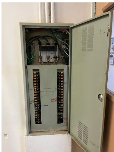
Figura 4 – Foto 3: vista aproximada do interior — disjuntor geral tripolar, barramentos e cabeamento de alimentação.
