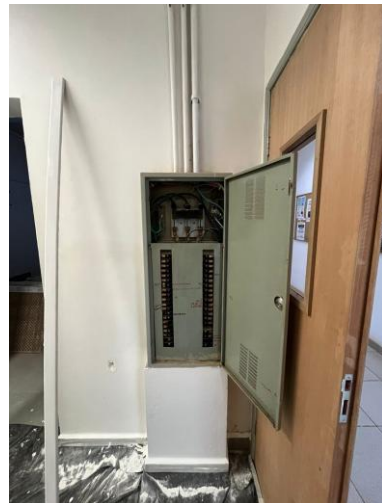
Figura 3 – Foto 2: quadro com a porta aberta — vista do conjunto, com disjuntor geral na parte superior e colunas de disjuntores.
