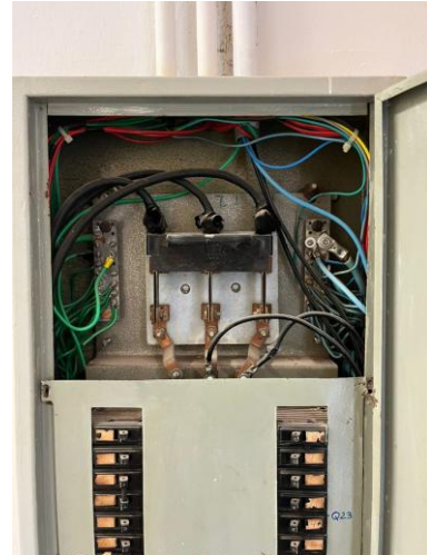
Figura 7 – Foto 6: detalhe superior — disjuntor geral, barramentos de fase e barra de aterramento, com cabeamento.
