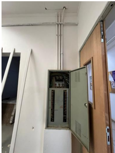
Figura 8 – Foto 7: vista do quadro no contexto do corredor, com eletrodutos aparentes de alimentação.
