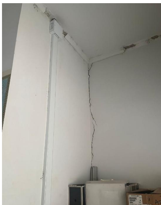
Figura 3 – Trinca presente no encontro de paredes
