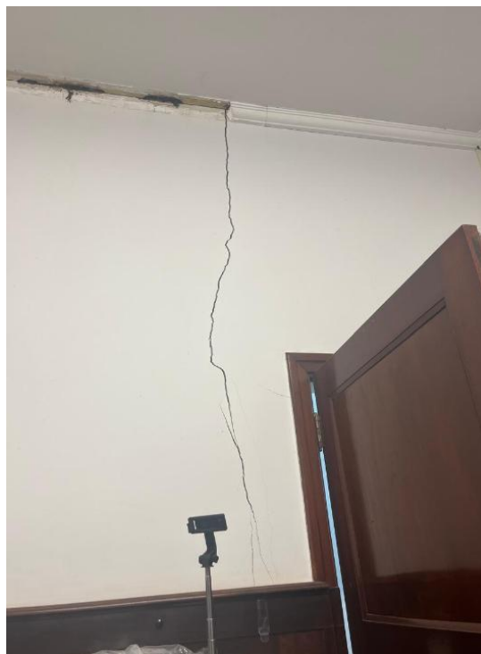
Figura 1 – Trinca ao longo do comprimento da parede
