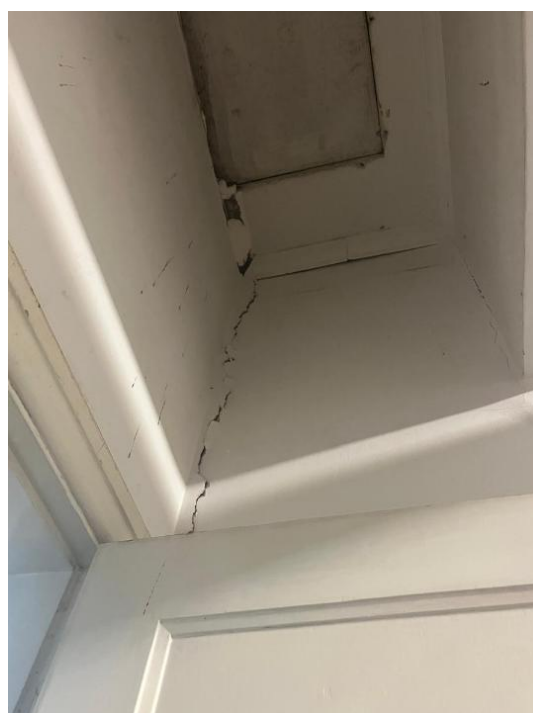
Figura 4 – Trinca presente no encontro de paredes
