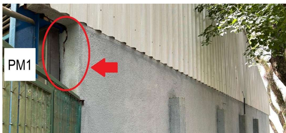
Figura 8 – Fissura na Parede 4 junto ao caixilho
