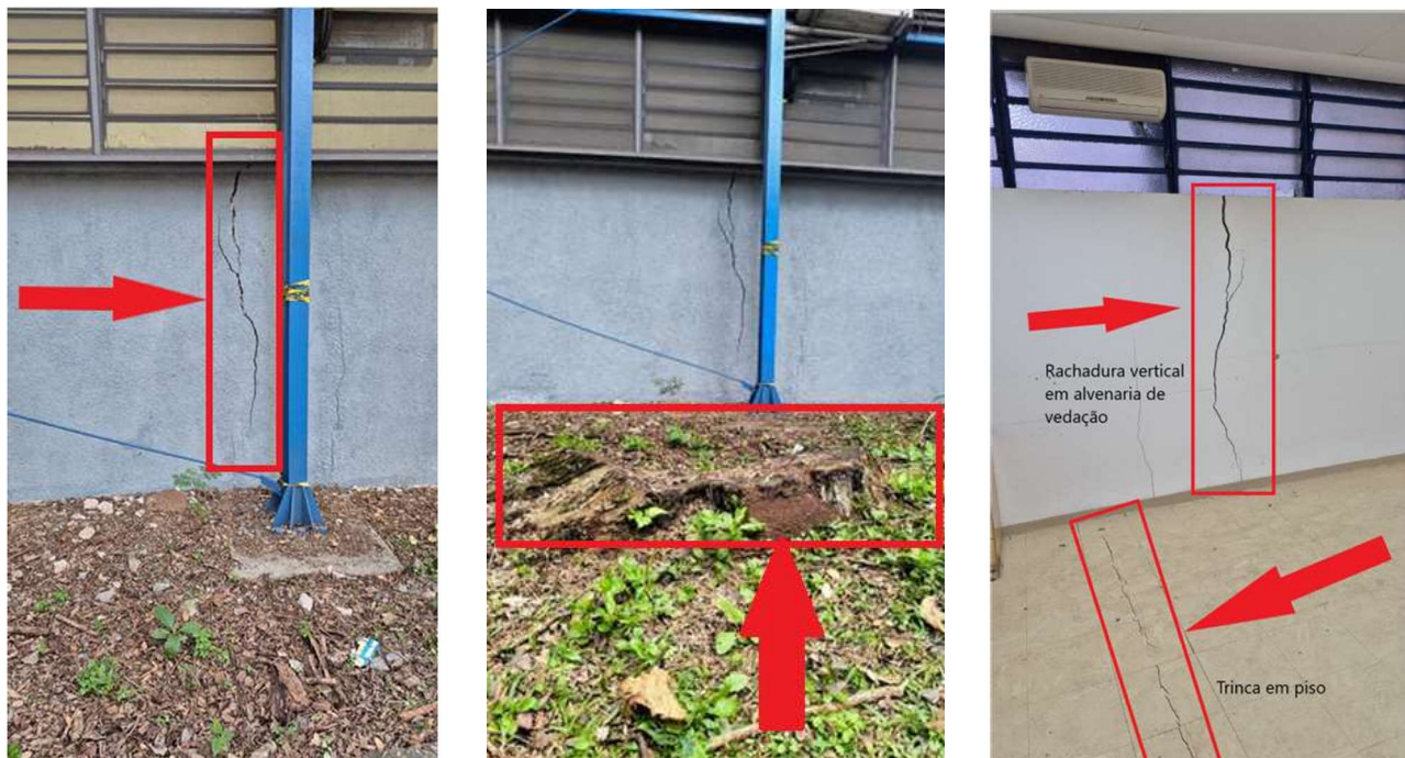
Figura 5 – Situação atual das salas, conforme Parecer Técnico [1].
