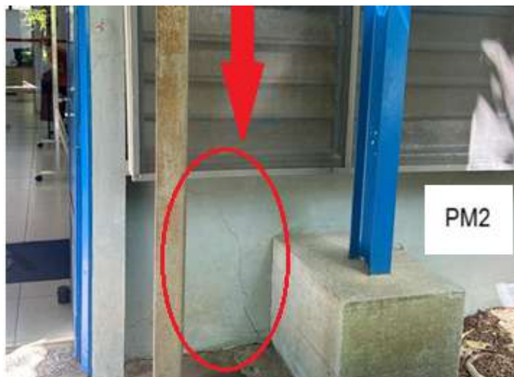
Figura 7 – Fissura na Parede 1 adjacente ao PM2.
