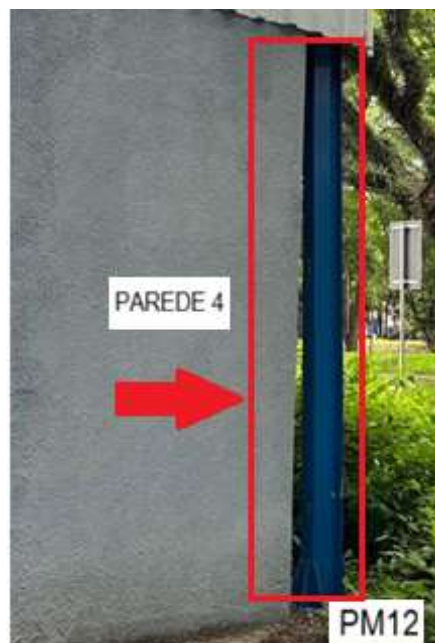
Figura 9 – Indício visual de desaprumo da Parede 4.
