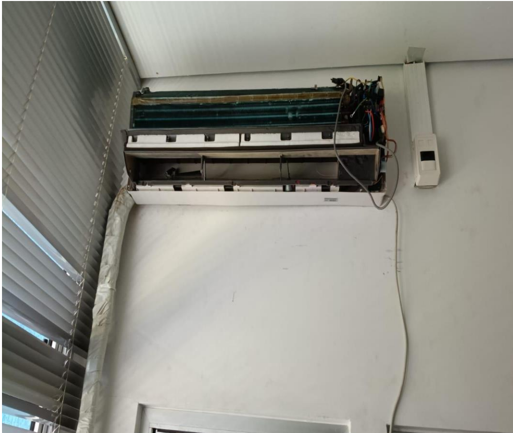
Foto 01 – Ar Condicionado Sala de Informática Equipamento C
