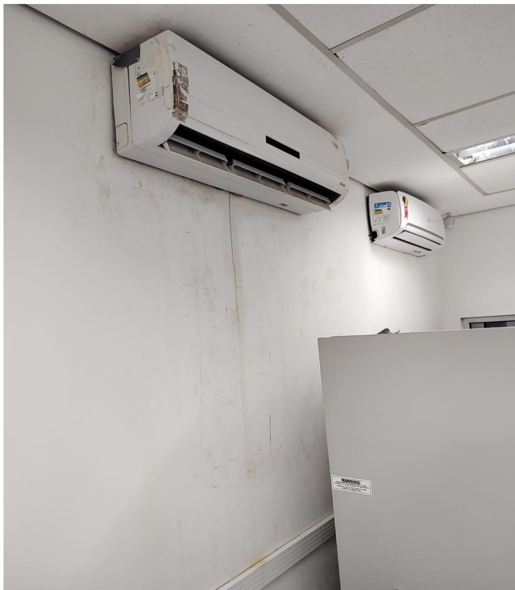
Foto 01 - Sala do Laboratório LAFEM, equipamento A e B, os forros são removíveis para passagem da tubulação nova
