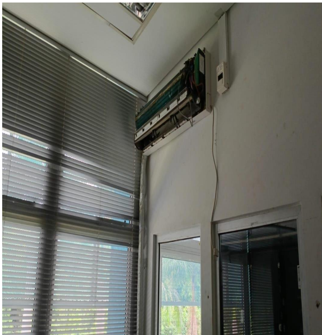
Foto 02 – Ar Condicionado Sala de Informática equipamento C
