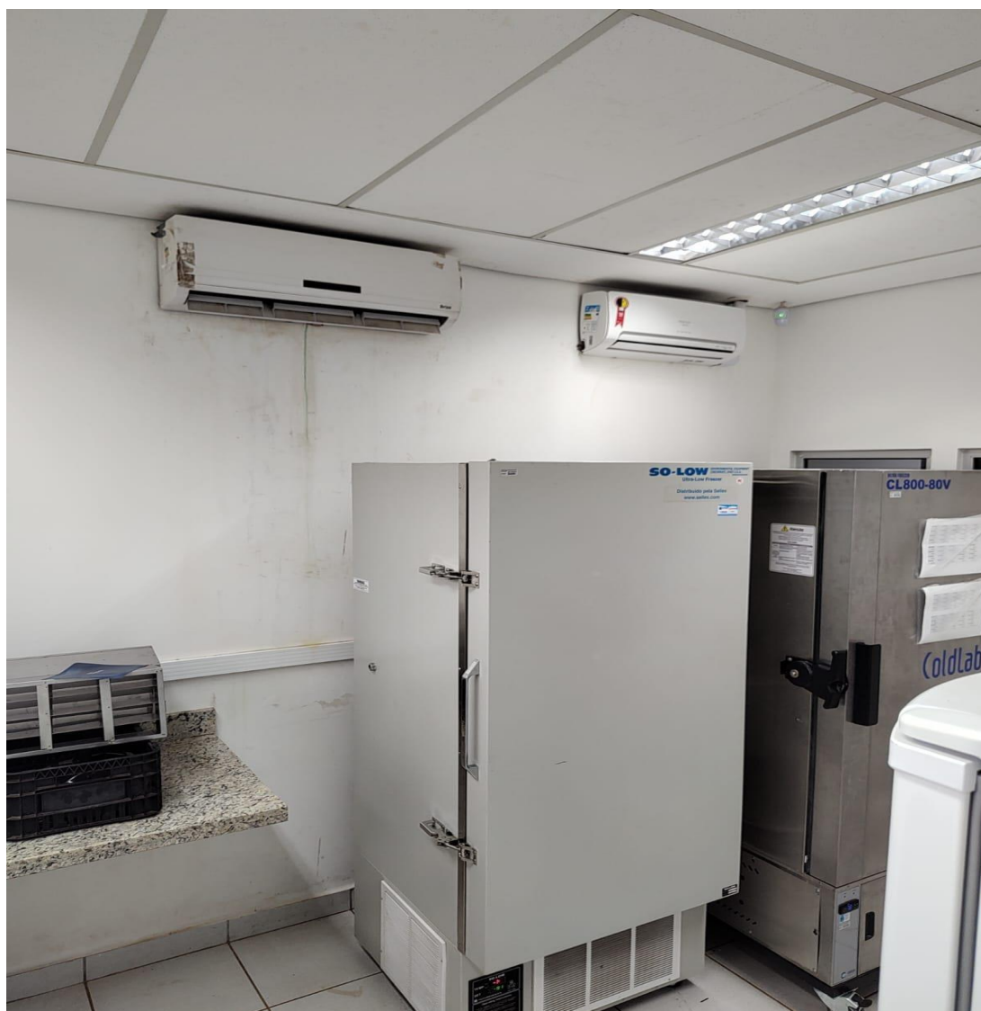
Foto 02 – Sala do Laboratório LAFEM, equipamento A e B Os drenos são embutidos na parede, acesso no fundo dos equipamentos.
