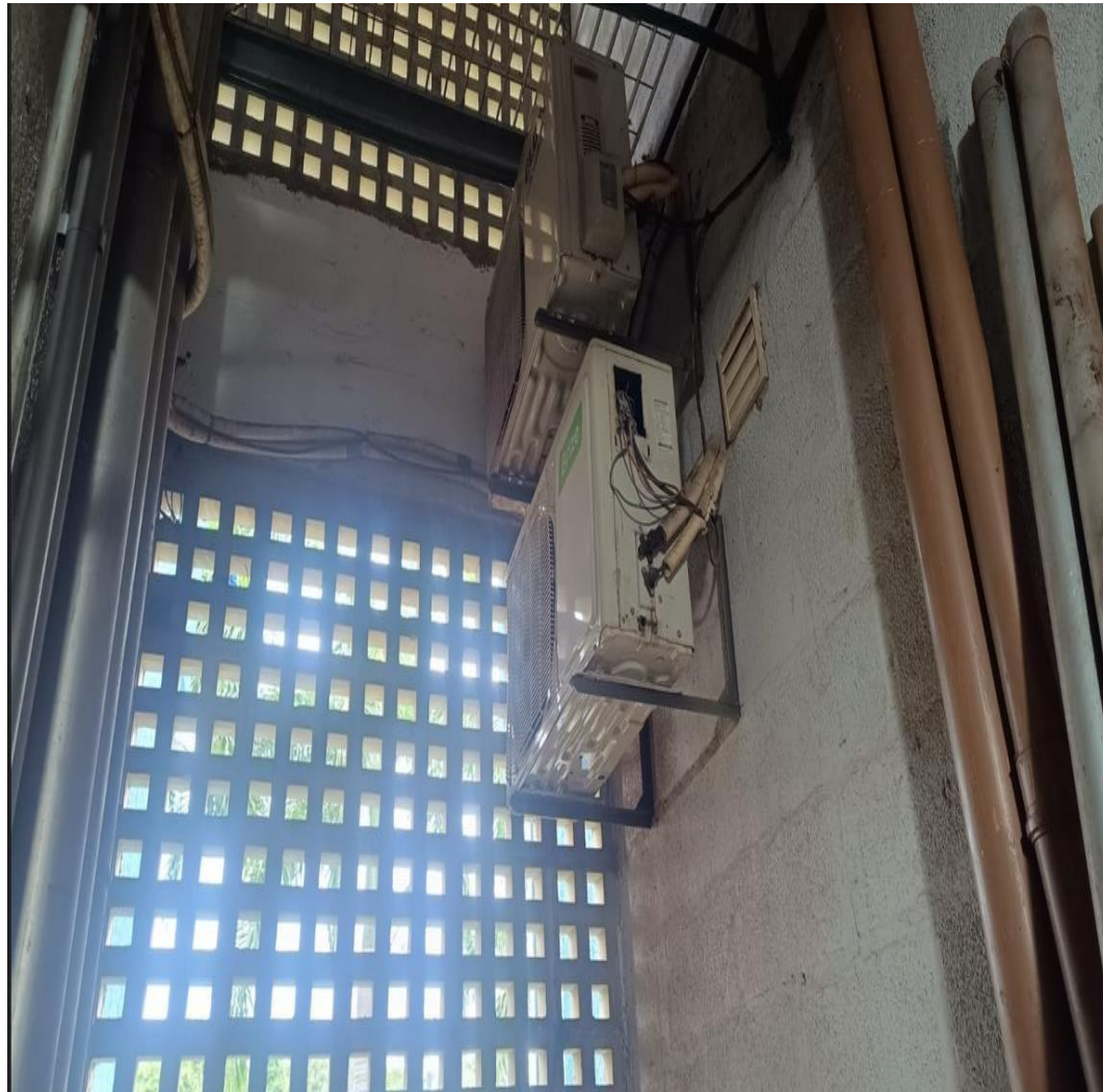
Condensadora equipamento A
