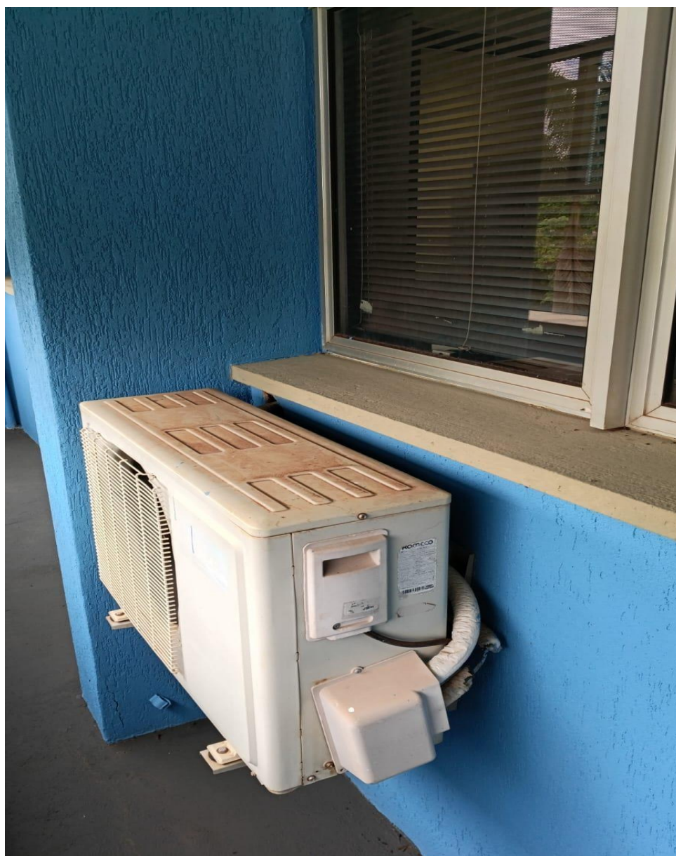
Foto 04 – Ar Condicionado Sala de Informática Unidade externa equipamento C
