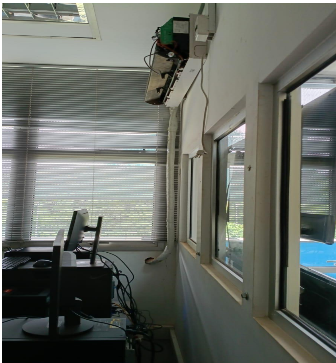
Foto 03 – Ar Condicionado Sala de Informática equipamento C
