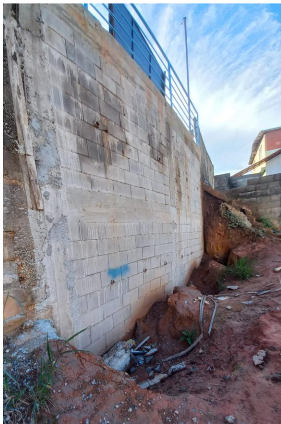
Imag. 05 – Deformação no centro e “pé” do muro de contenção.
