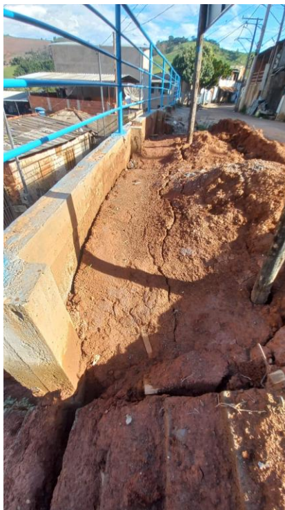
Imag. 02 – Aterro sem compactação – Deformação do muro.
