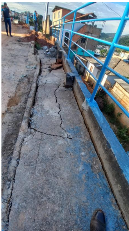
Imag. 03 – Trincas em piso de concreto – Sequências de muro.
