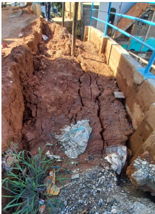
Imag. 01 – Aterro sem compactação – Empuxo excessivo.
