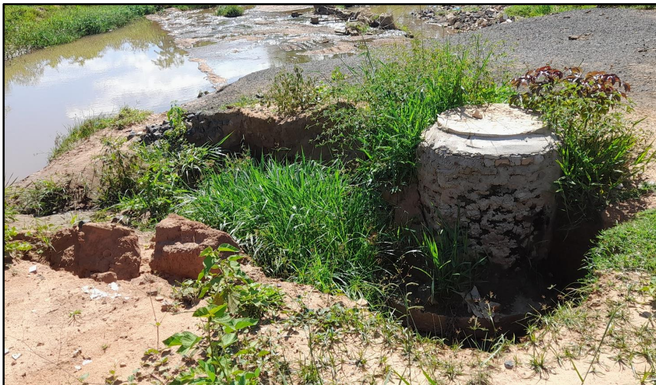
Figura 3: Erosão do solo adjacente ao poço de visita, devido à transbordamentos causados pela obstrução
