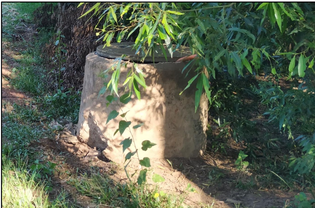
Figura 4: Ponto final do trecho 1, poço de visita danificado
