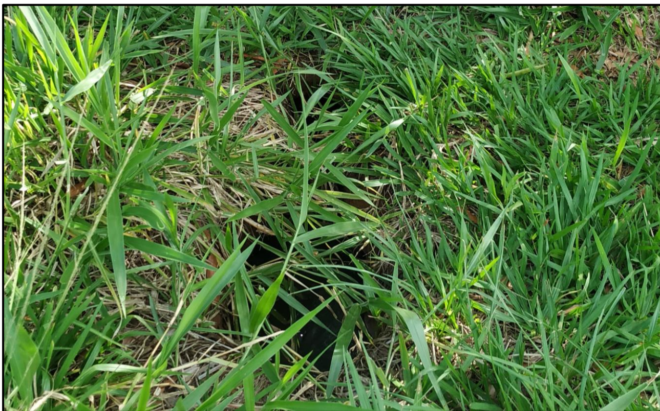
Figura 5: Ponto final do trecho 2, geratriz superior do tubo danificada
