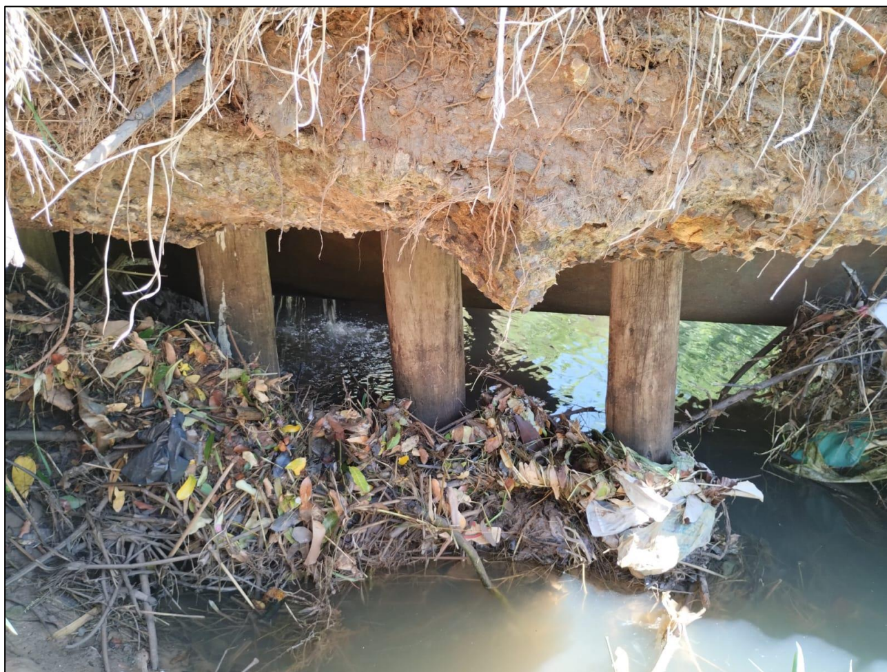
Figura 02: Interceptor de esgoto às Margens do Córrego Marinheirinho – Ponto 01.
