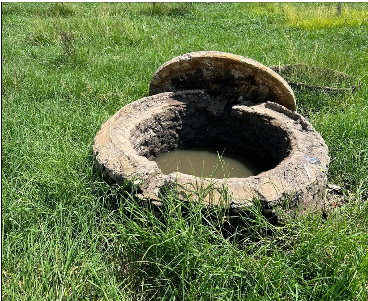
Figura 03: Interceptor de esgoto obstruído às Margens do Córrego Marinheirinho – Ponto 02.
