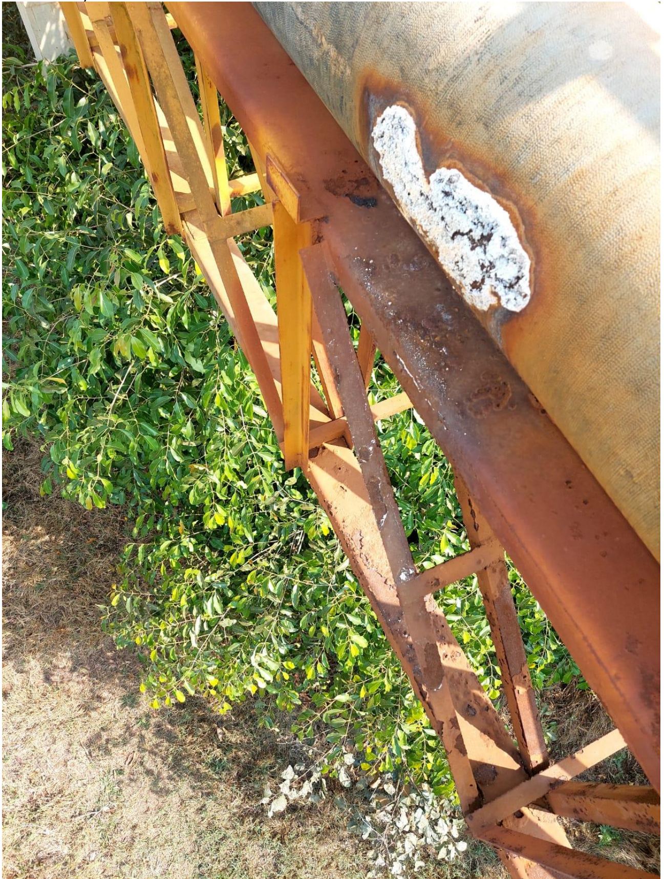
Figura 9: Detalhe de barras da treliça enferrujadas e tubos com patologias (Travessia sobre o Córrego Marinheirinho)
