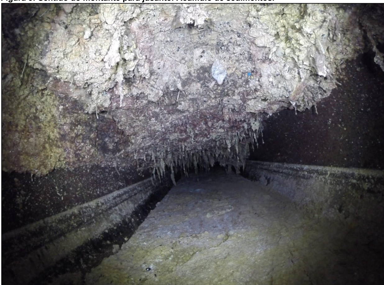
Figura 3: Sentido do montante para jusante: Acúmulo de sedimentos.
