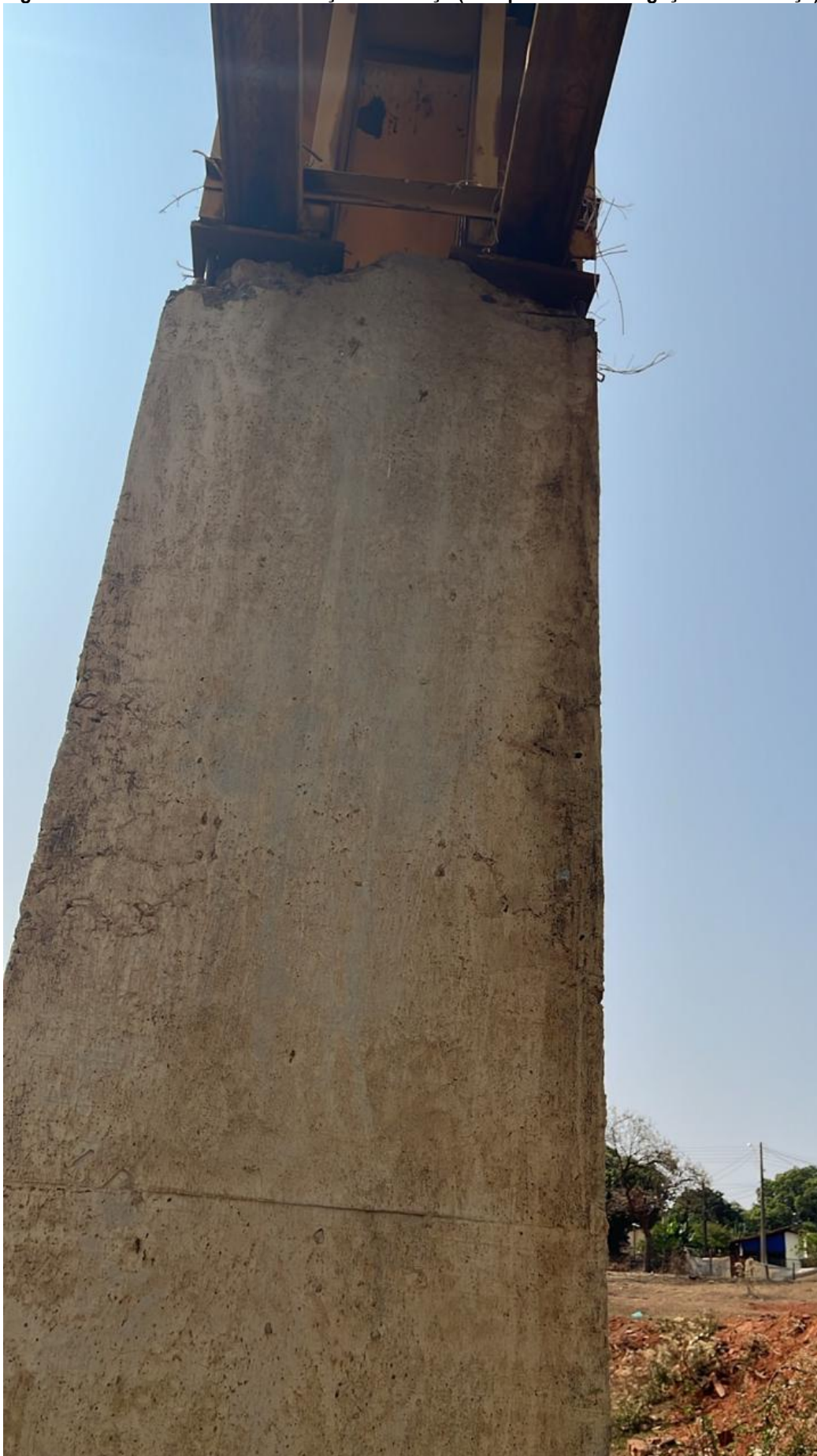
Figura 10: Detalhe Pilar de Sustentação da Treliça (com problemas na ligação Pilar/Treliça)
