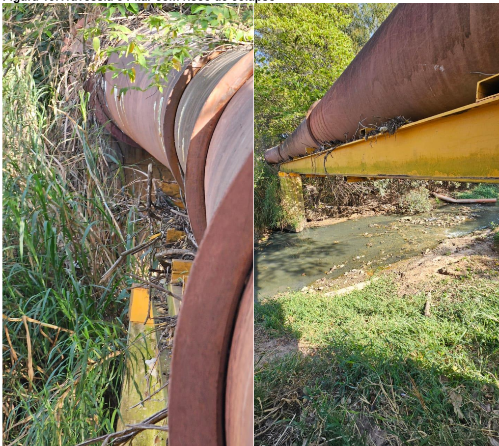
Figura 13: Travessia e Pilar com risco de colapso
