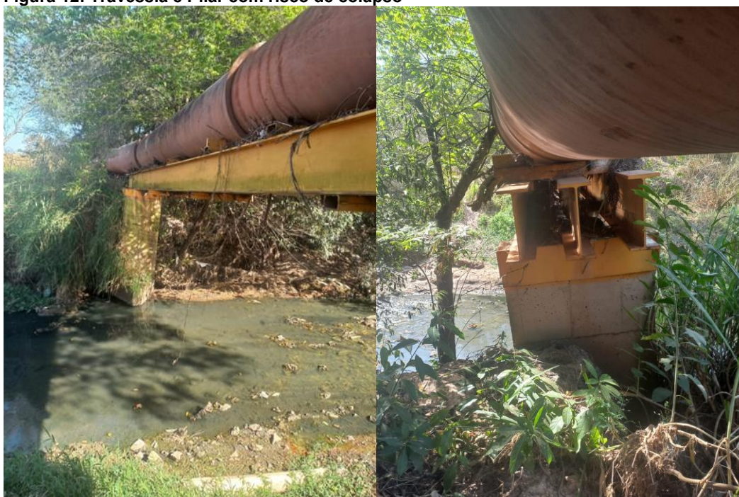
Figura 12: Travessia e Pilar com risco de colapso
