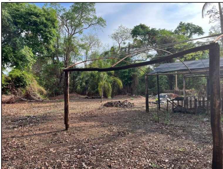
Figura 11: Viveiro de mudas 02 – condição atual da estrutura de cobertura
