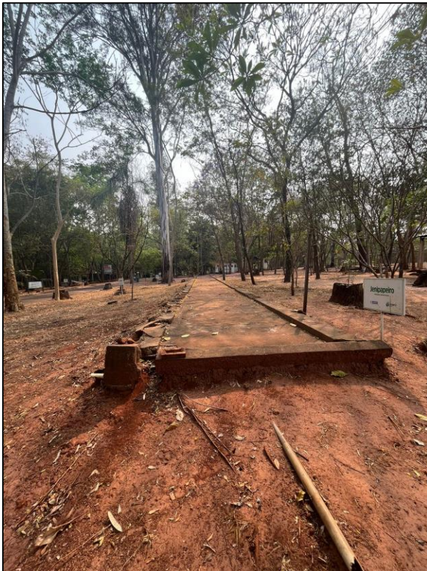
Figura 14: Estrutura desativada e deteriorada
