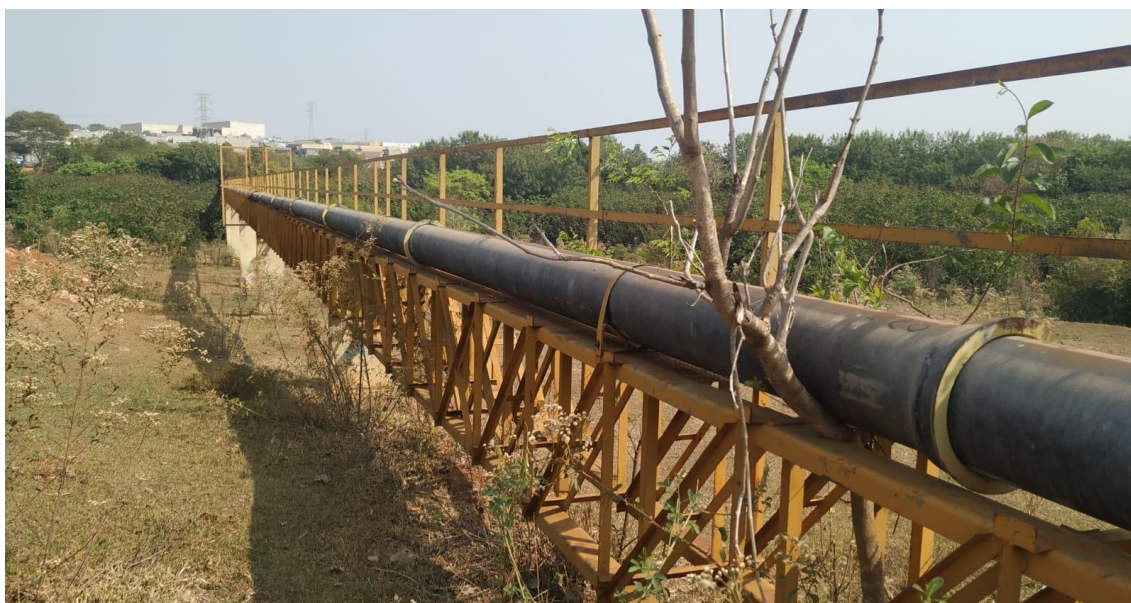
Figura 3: As condições locais apresentam invasão de vegetação com troncos finos entrelaçando travessia e tubulação, podendo vir a ocorrer rupturas, movimento de bolsas e esforço adicional.
