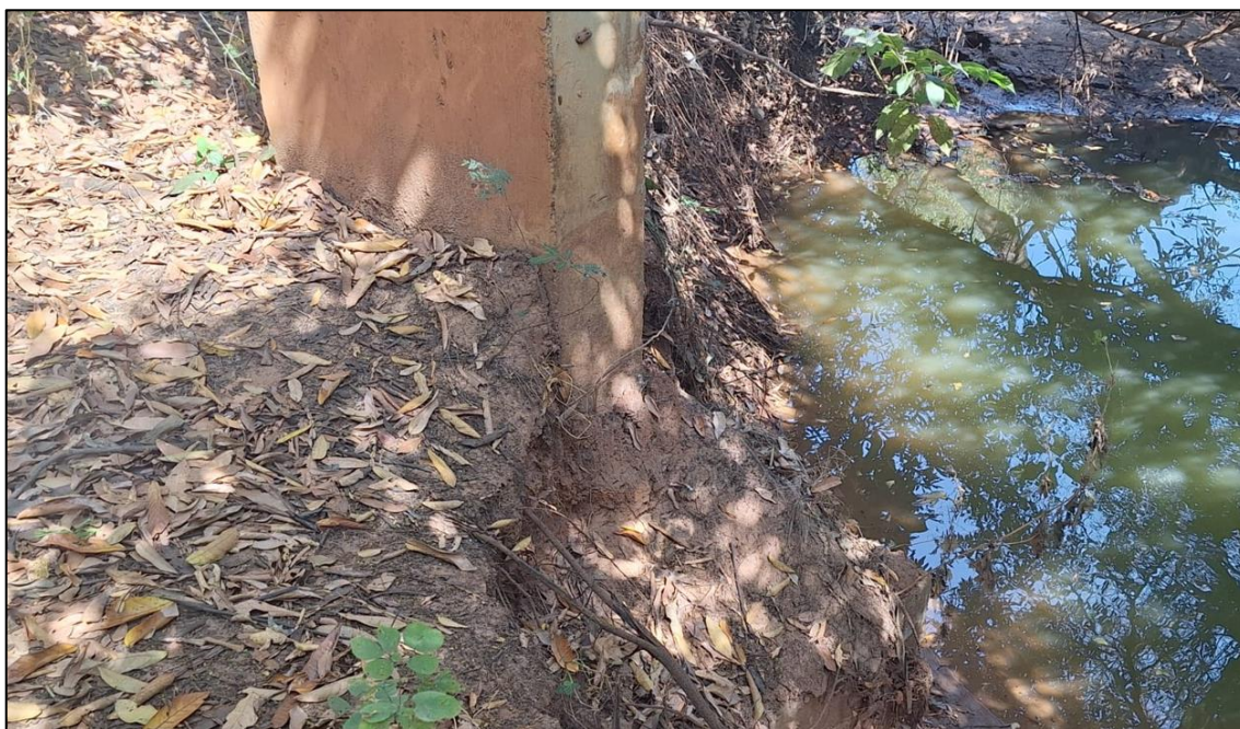
Figura 7: As condições dos pilares apresentam necessidade de proteção da base.
