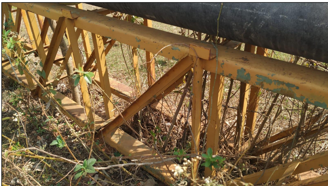
Figura 8: As condições da treliça metálica apresentam necessidade de lixamento e pintura.
