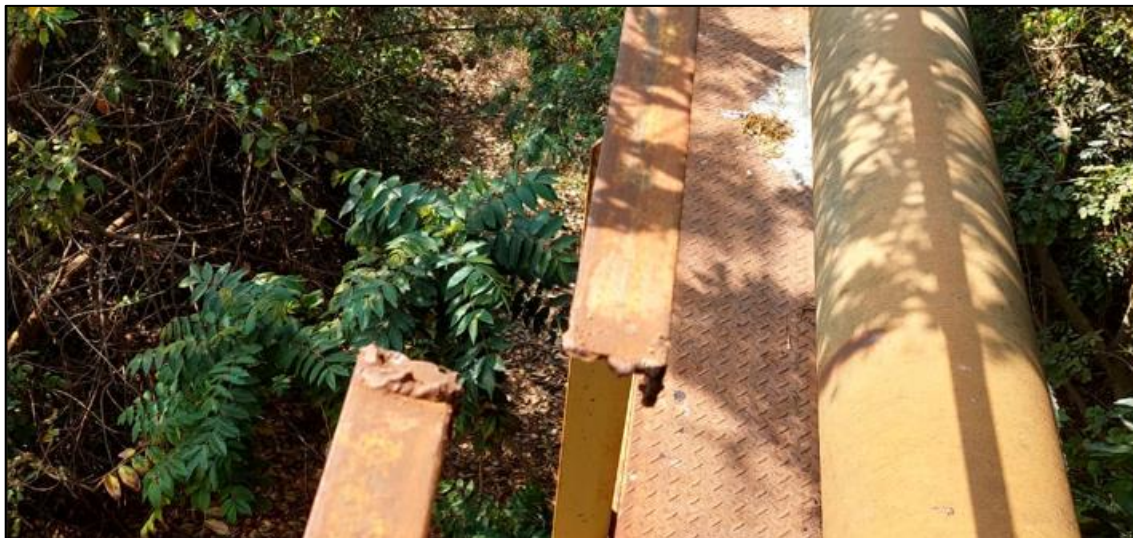
Figura 10: As condições da treliça metálica apresentam pontos expressivos de corrosão com a necessidade de substituição de elementos metálicos.
