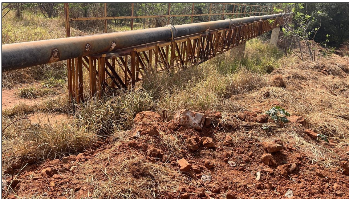
Figura 11: As condições da tubulação apresentam pontos expressivos de corrosão com a necessidade de substituição dos elementos.
