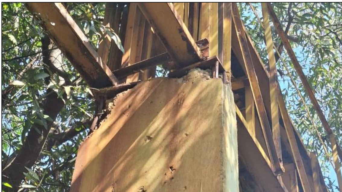
Figura 6: As condições dos pilares apresentam necessidade de reparo do topo.
