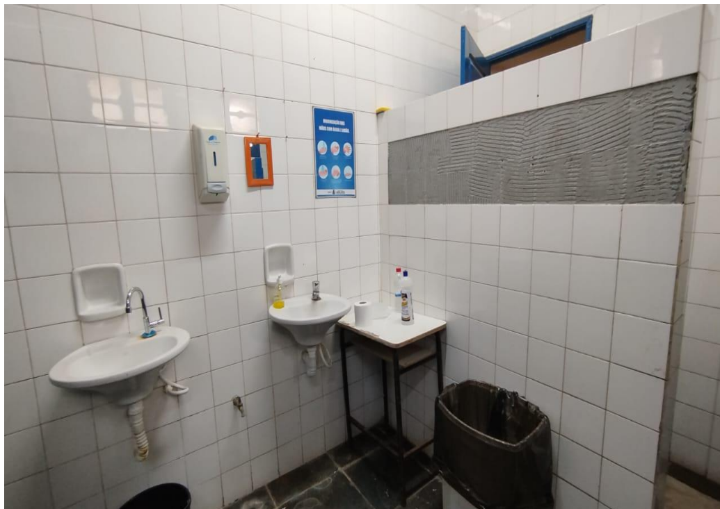
Foto 6 – Sanitário feminino subsolo.
