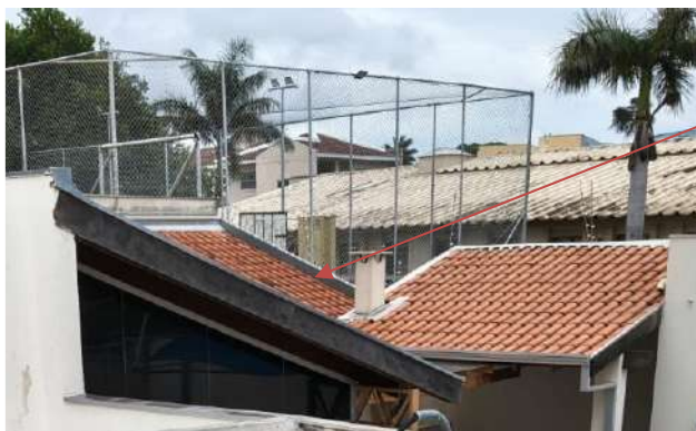
Telhas quebradas ou deslocadas
