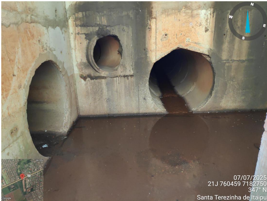
FOTO 08 – Caixa de passagem com águas circulando sendo direcionadas para o Parque Ecológico Domingos Zanette. (Fonte: Autoria própria, registrada em 07/07/2025).
