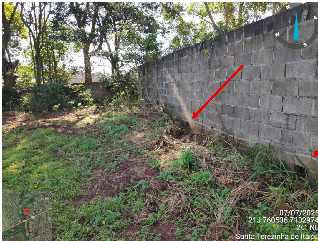
FOTO 25 – Ponto de surgência de drenagem pluvial. (Fonte: Autoria própria, registrada em 03/07/2025).
