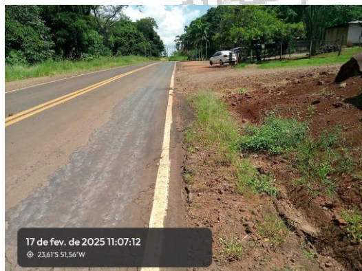
Figura 4 – Danos por falha de drenagem
