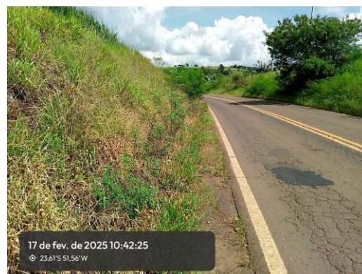
Figura 3 – Reparo executado sem técnica
