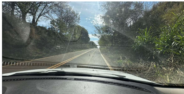
8 - trecho com canaletas destruídas
