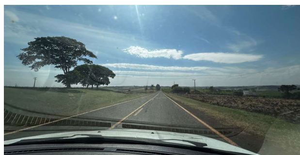
4 - trecho com capa deteriorada
