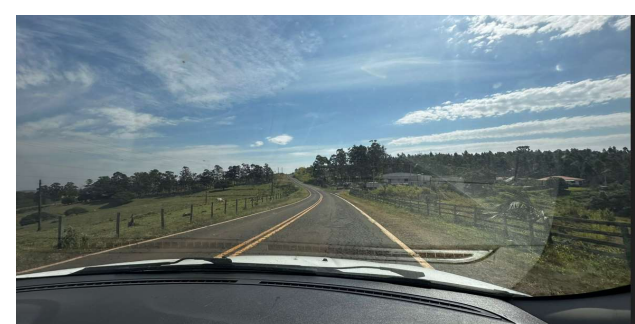
12 - capa asfáltica com problemas
