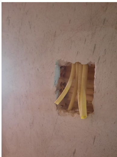
Espaço onde será instalado o Quadro de Distribuição
