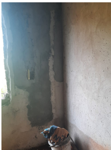
Parede faltando pontos elétricos e hidráulicos da Sala V.S.
