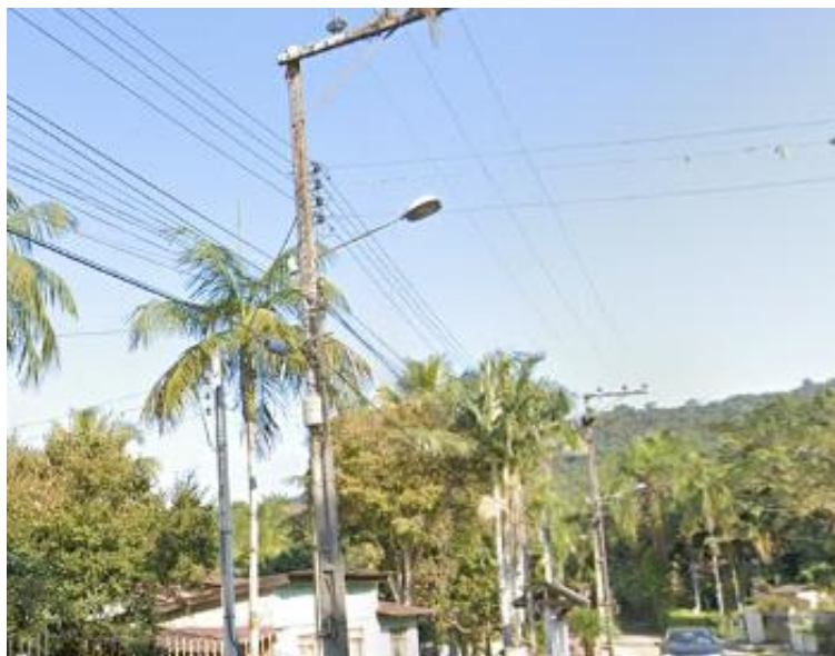
Figura 9 - Exemplo iluminação pública de vapor de sódio 70 W
