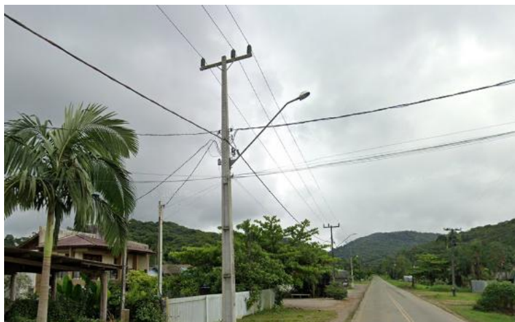
Figura 4 - Exemplo iluminação pública de vapor de sódio 250 W
