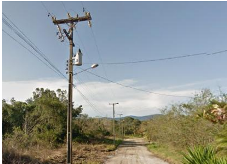
Figura 8 - Exemplo iluminação pública de vapor de sódio 100 W
