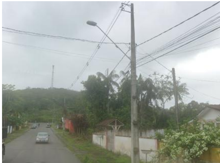
Figura 6 - Exemplo iluminação pública de vapor de sódio 150 W
