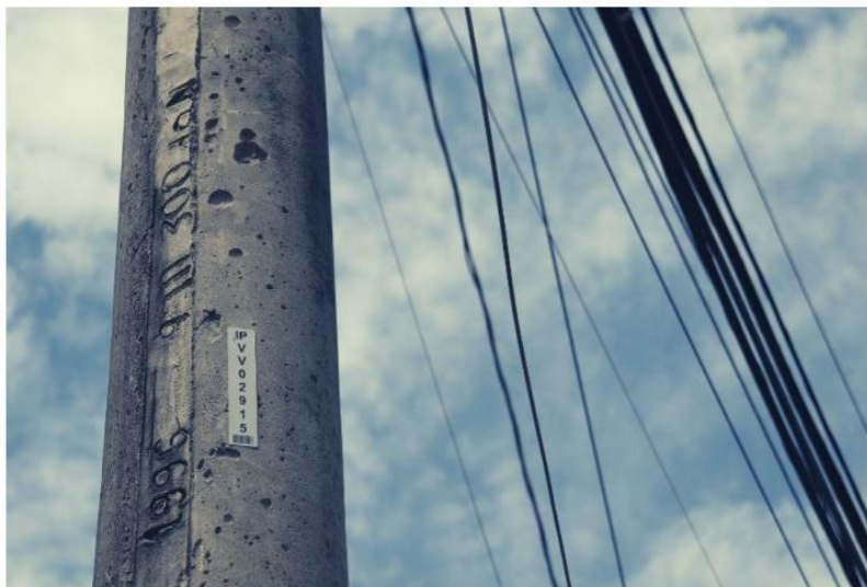
Figura 2 – Padrão de fixação no poste da iluminação pública
