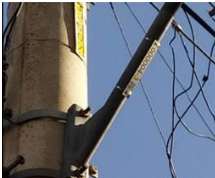
Figura 1 – Padrão de fixação no braço da iluminação pública
