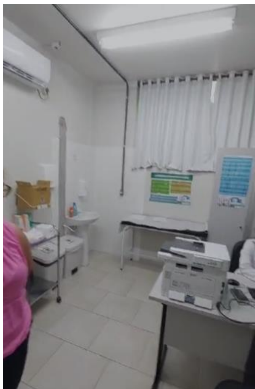
Figura 4: Sala de vacinas – revestimento cerâmico precário e pia sem bancada insuficiente para atividade.
