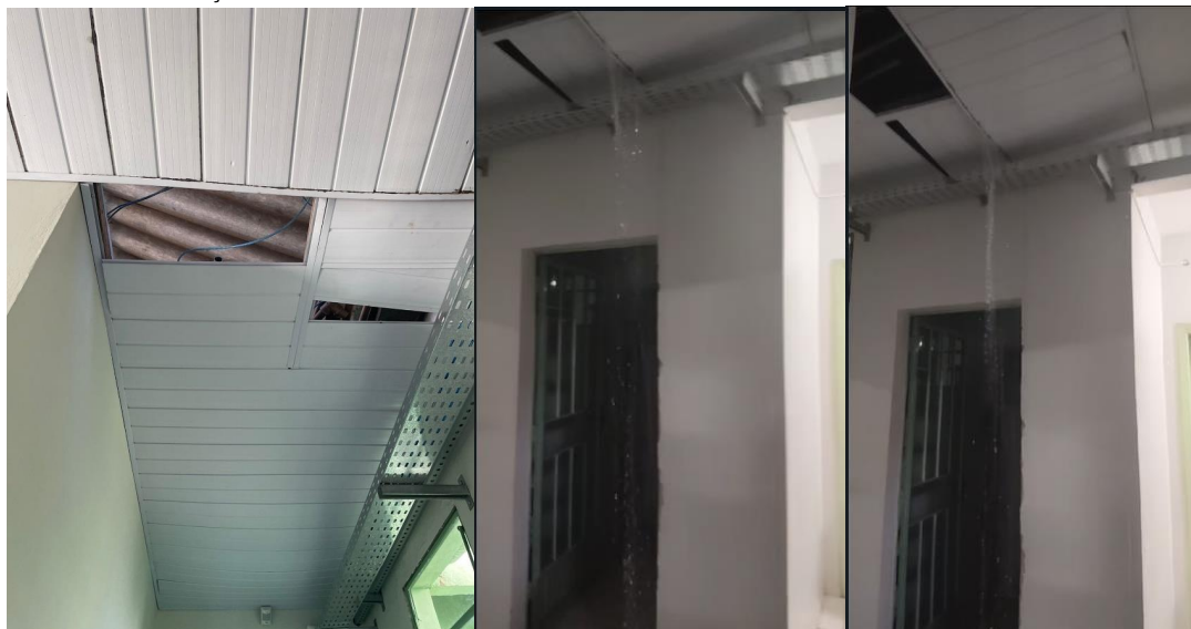
Figura 2: Circulação Central – Forro degradado e registro de grande volume de água infiltrando via telhado em condições de chuvas torrenciais.
