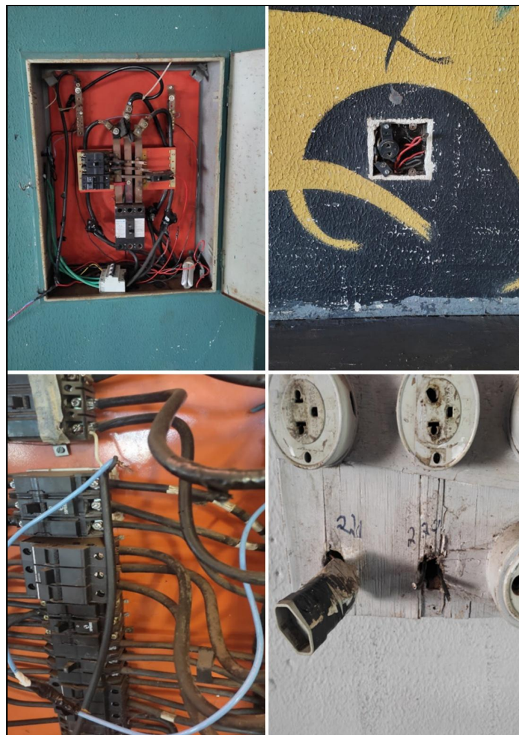
FIGURA 7: INSTALAÇÕES ELÉTRICAS DETERIORADAS.
