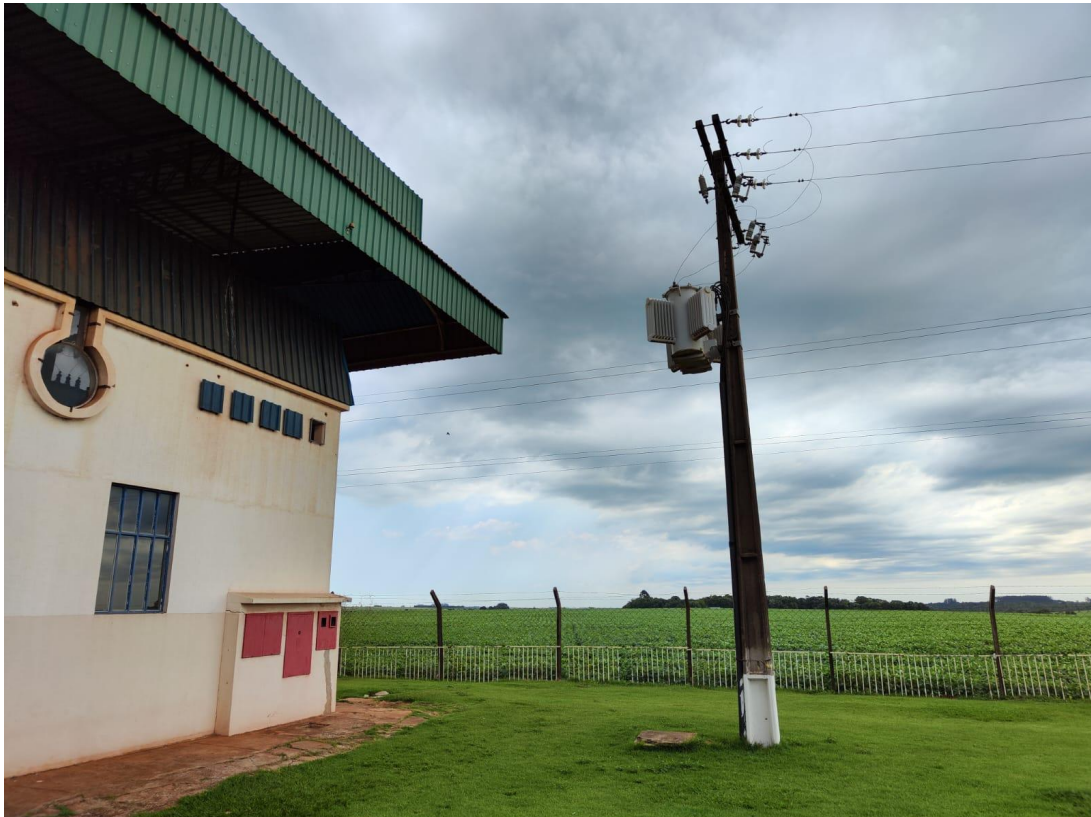
FIGURA 35: Transformador A e mureta de bomba de incêndio. Fonte: Acervo próprio.
