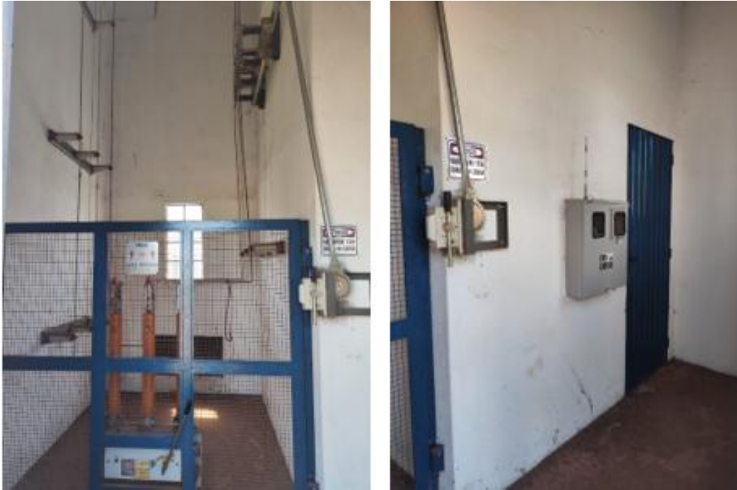
FIGURA 33: Vista interna entrada de energia, proteção geral. Fonte: Acervo próprio.
