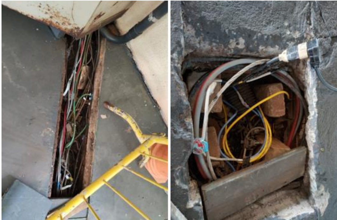
FIGURA 38: Canaletas no piso, emendas e uso de cabo de alumínio.
