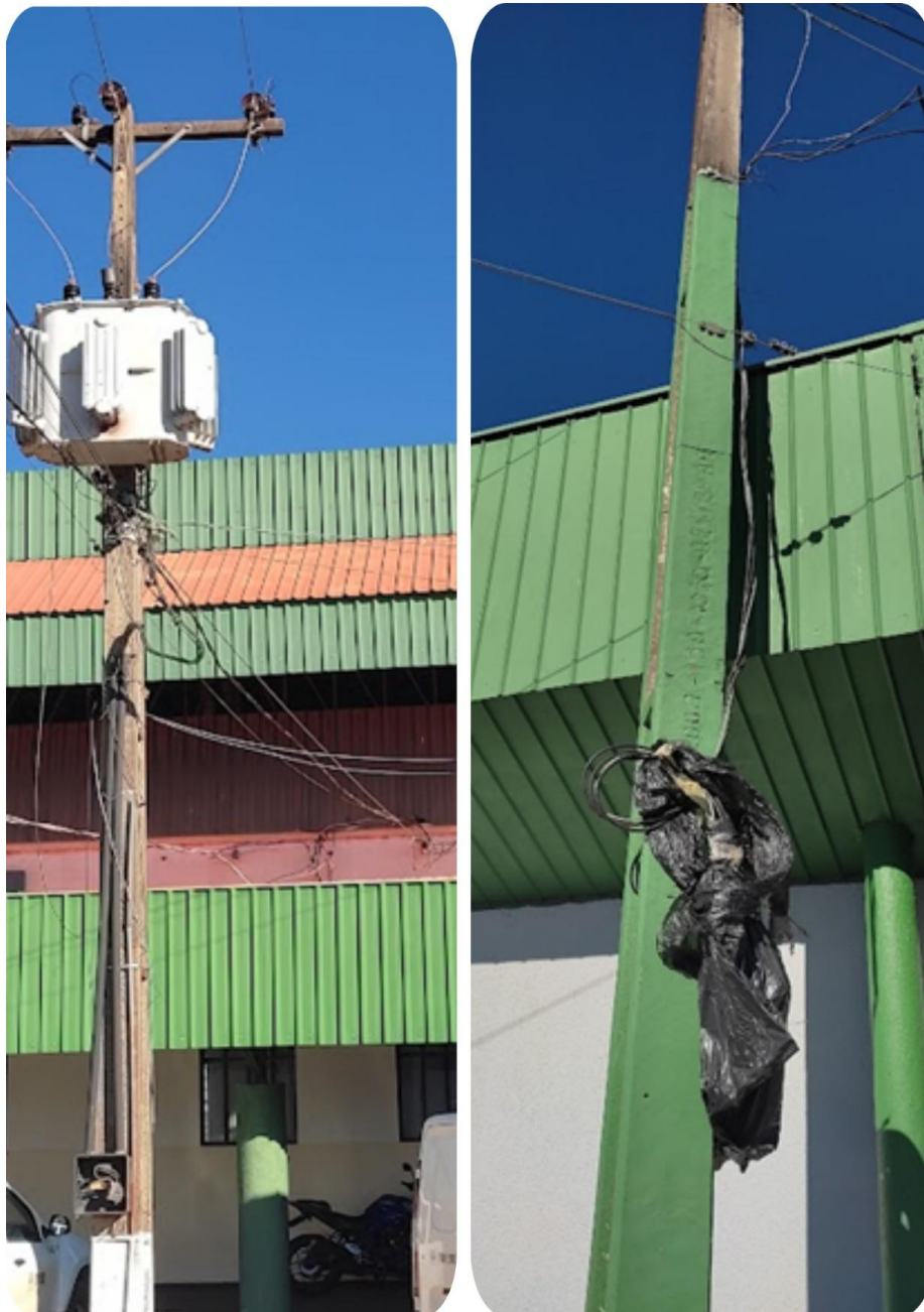
FIGURA 8: FIAÇÃO DETERIORADA E CONSERTOS PRECÁRIOS.
