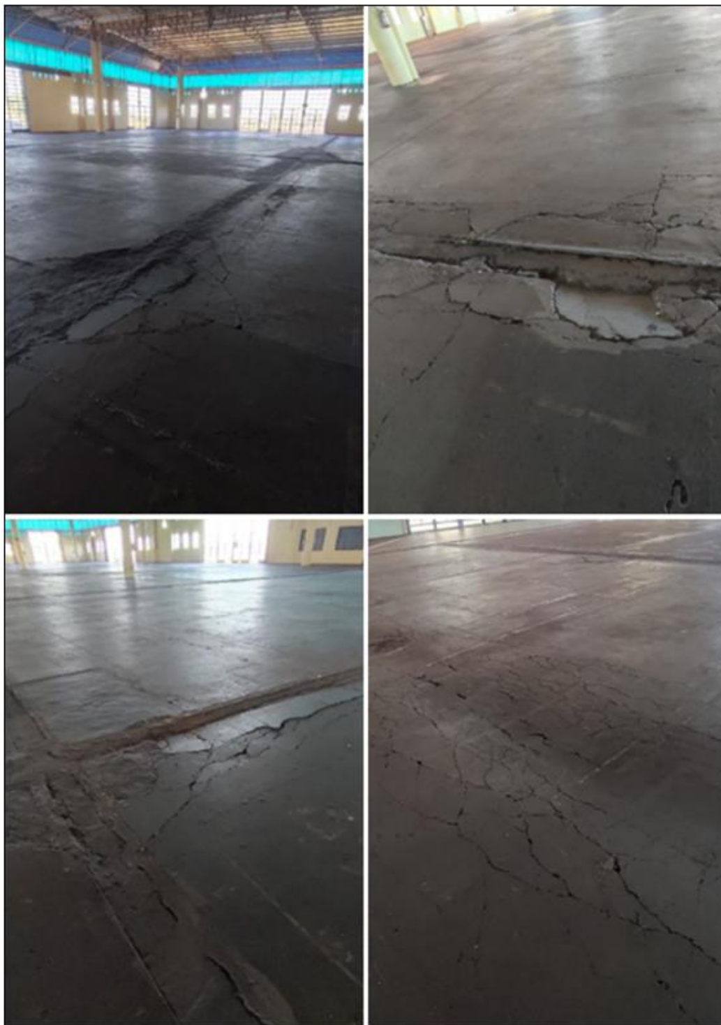
FIGURA 10: DETERIORAÇÃO DO PISO DO CENTRO DE EVENTOS.
