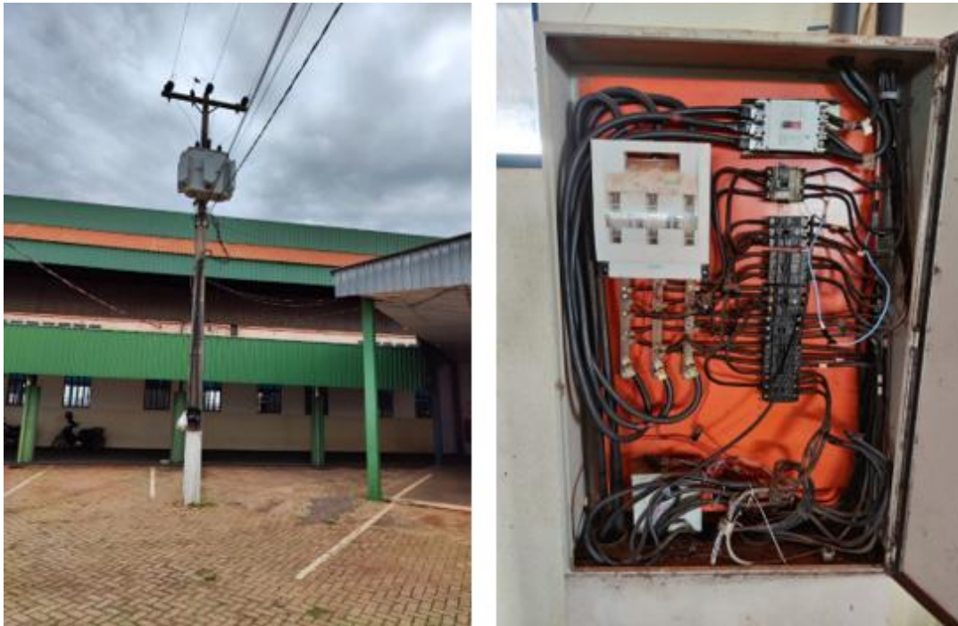
FIGURA 36: Transformador B e quadro de distribuição. Fonte: Acervo próprio.
