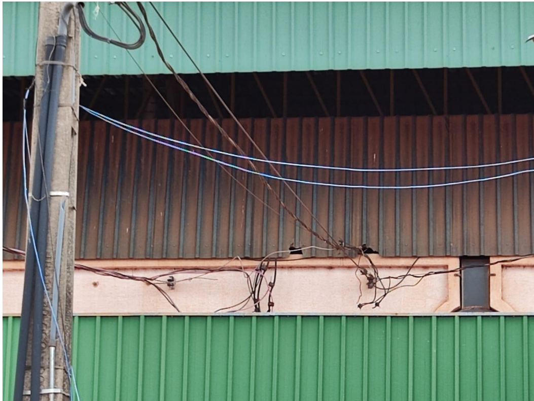
FIGURA 39: Derivações destinadas INFRA e a área das cozinhas sem proteções.
