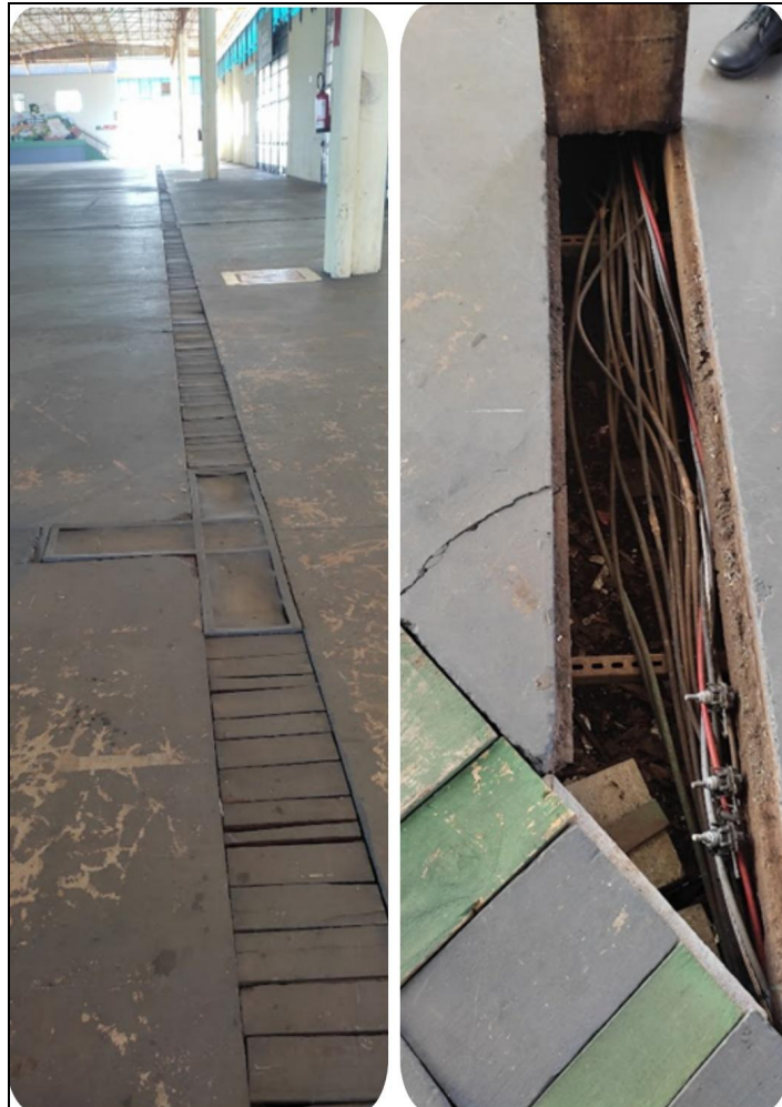
FIGURA 6: FIAÇÃO NAS CANALETAS.
