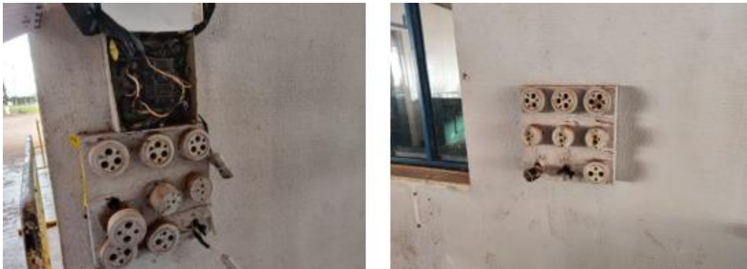
FIGURA 40: Conjunto de Tomadas existente na praça de alimentação.
