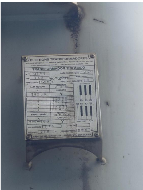
Figura 3 – Placa de identificação do transformador
