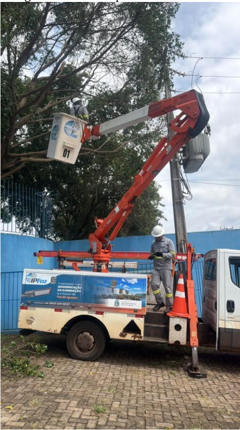
Figura 6 – Poda emergencial realizada pela IPFOZ no entorno do transformador
