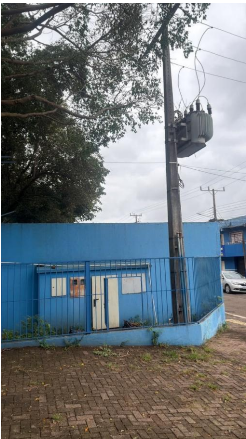
Figura 2 – Vista geral da entrada de energia
