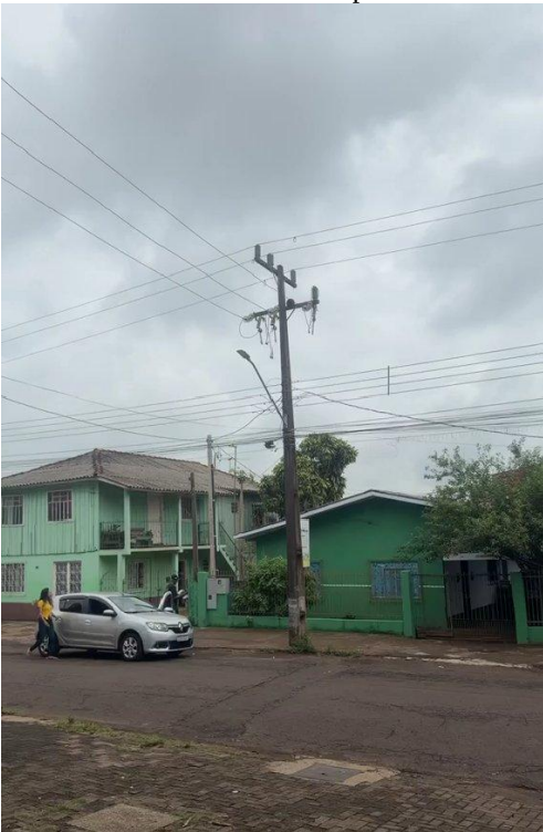
Figura 1 – Chaves fusíveis abertas no poste da rede da COPEL
