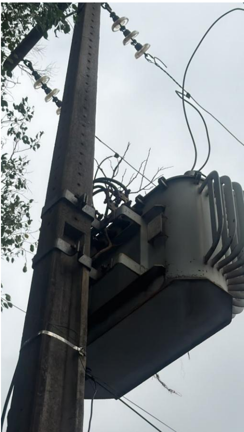
Figura 5 – Galhos presos junto às buchas do transformador
