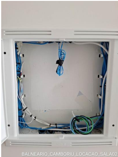
Figura 3.11 – Quadro de telecomunicação
