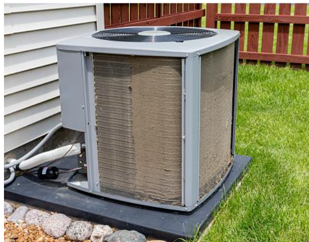
Figura 2: Condensadora (item 01) com muita sujeira acumulada.
