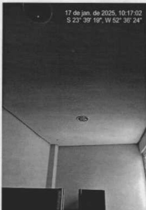
Imagem 06 – Forro de gesso apresentado humidade, necessita reparos. (piso superior)
