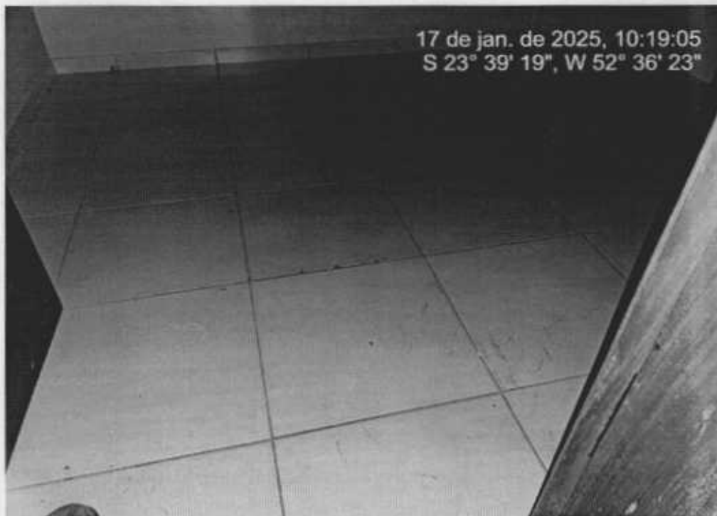
Imagem 05 – Piso estufado, necessita ser reparado (piso superior).
