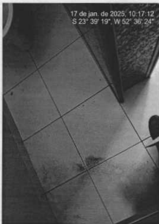
Imagem 07 – Piso trincado no banheiro no segundo pavimento (apenas para registro).
