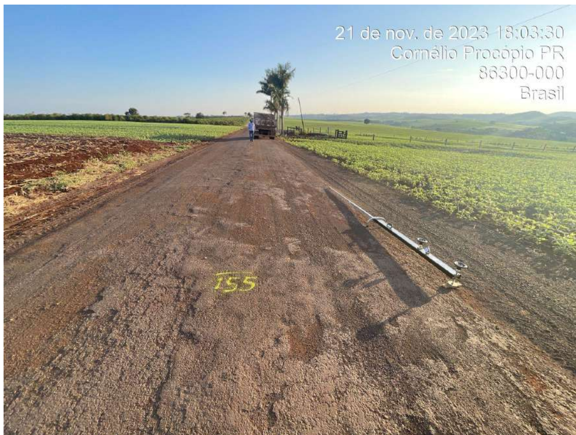
Figura 2. Pavimento apresentando grande desgaste superficial. Fonte: Os Autores.
