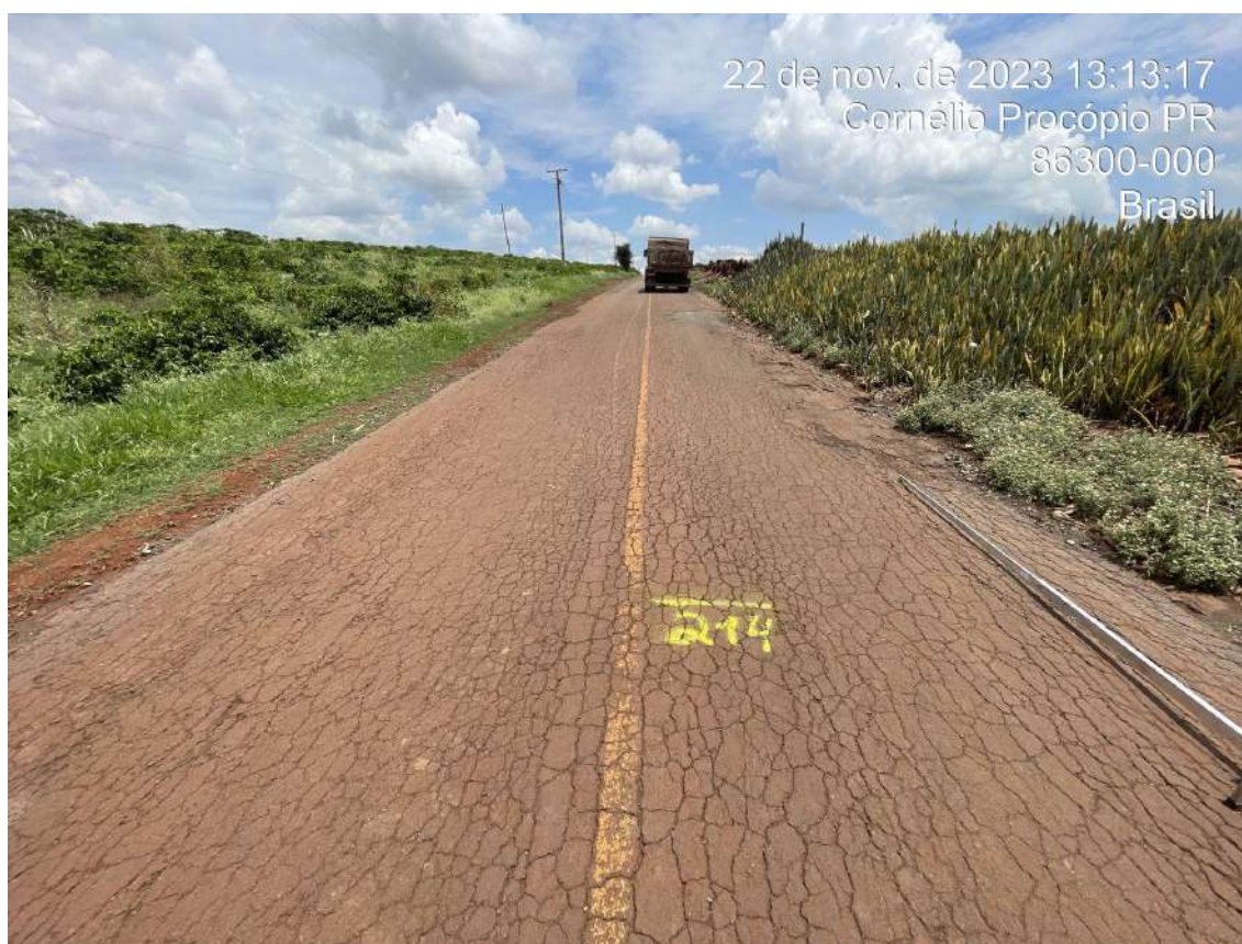
Figura 1. Situação atual do pavimento com trincas tipo couro de jacaré. Fonte: os Autores.
