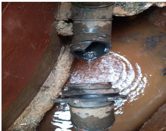
FOTO 1 – TUBULAÇÃO NA BASE DO RESERVATÓRIO ROMPIDA
