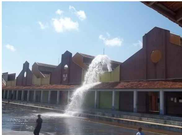
FOTO 2 – ROMPIMENTO DE TUBULAÇÃO DE ÁGUA
