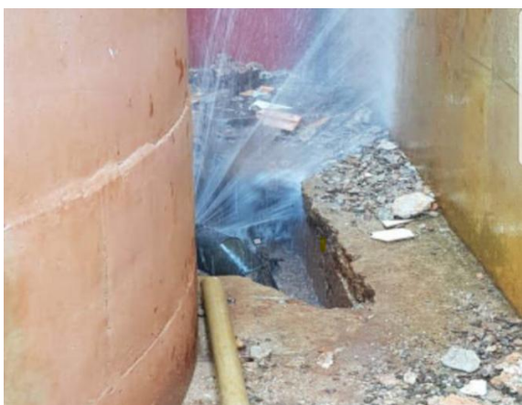
FOTO 11 – TUBULAÇÃO NA BASE DO RESERVATÓRIO ROMPIDA
