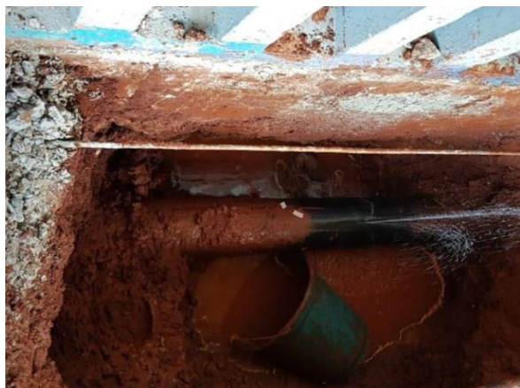
FOTO 6 – TUBULAÇÃO ENTERRADA COM VAZAMENTO
