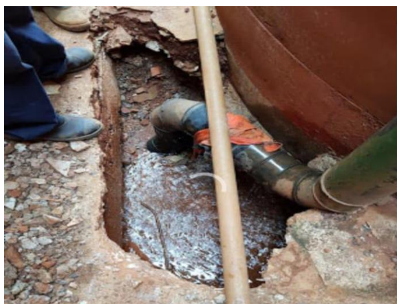
FOTO 12 – CONCERTO DE TUBULAÇÃO
