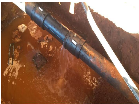
FOTO 9 – TUBULAÇÃO COM VAZAMENTO (ANTES)
