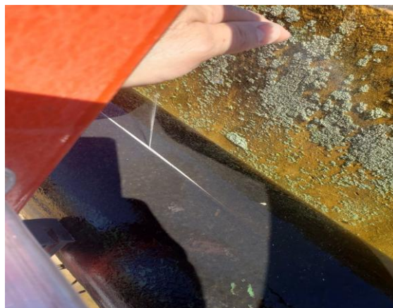
FOTO 14 – TUBULAÇÃO COM INÍCIO DO VAZAMENTO/ROMPIMENTO
