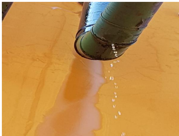
FOTO 4 – VAZAMENTO DE TUBULAÇÃO
