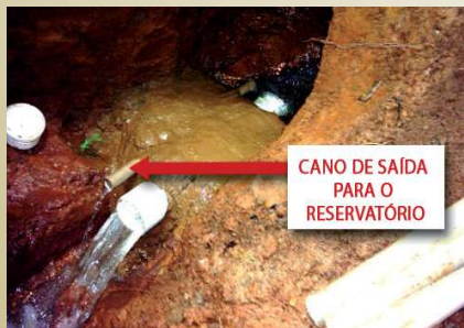
Figura 25 Cano de saída da água para o reservatório ou córrego
