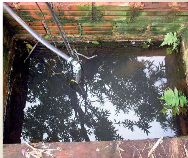
Figura 16 - Captação inadequada em nascente assoreada.
