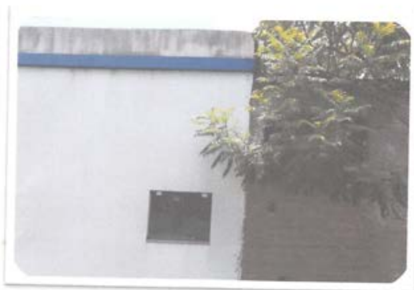
Secretaria da Câmara e obra inacabada
