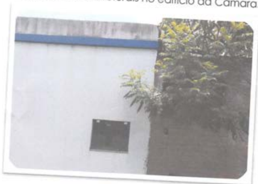
Secretaria da Câmara e obra inacabada
