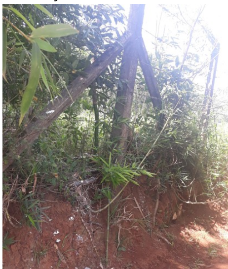
Foto 2 - Situação atual, cerca danificada, risco desabamento
