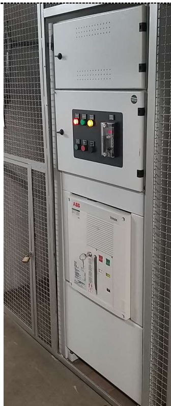
FIGURA 5 – DISJUNTOR DE MT
