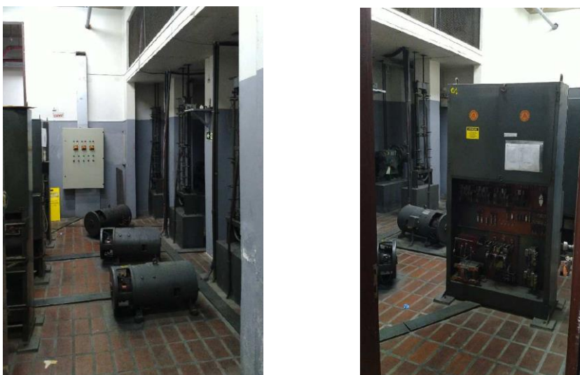
Figura 1 - Sala de máquinas
