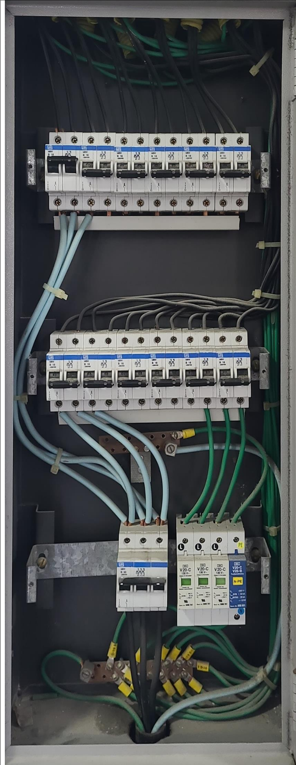
Fotografia 16 – Situação atual do QD-AC SUPERIOR CORREDOR
