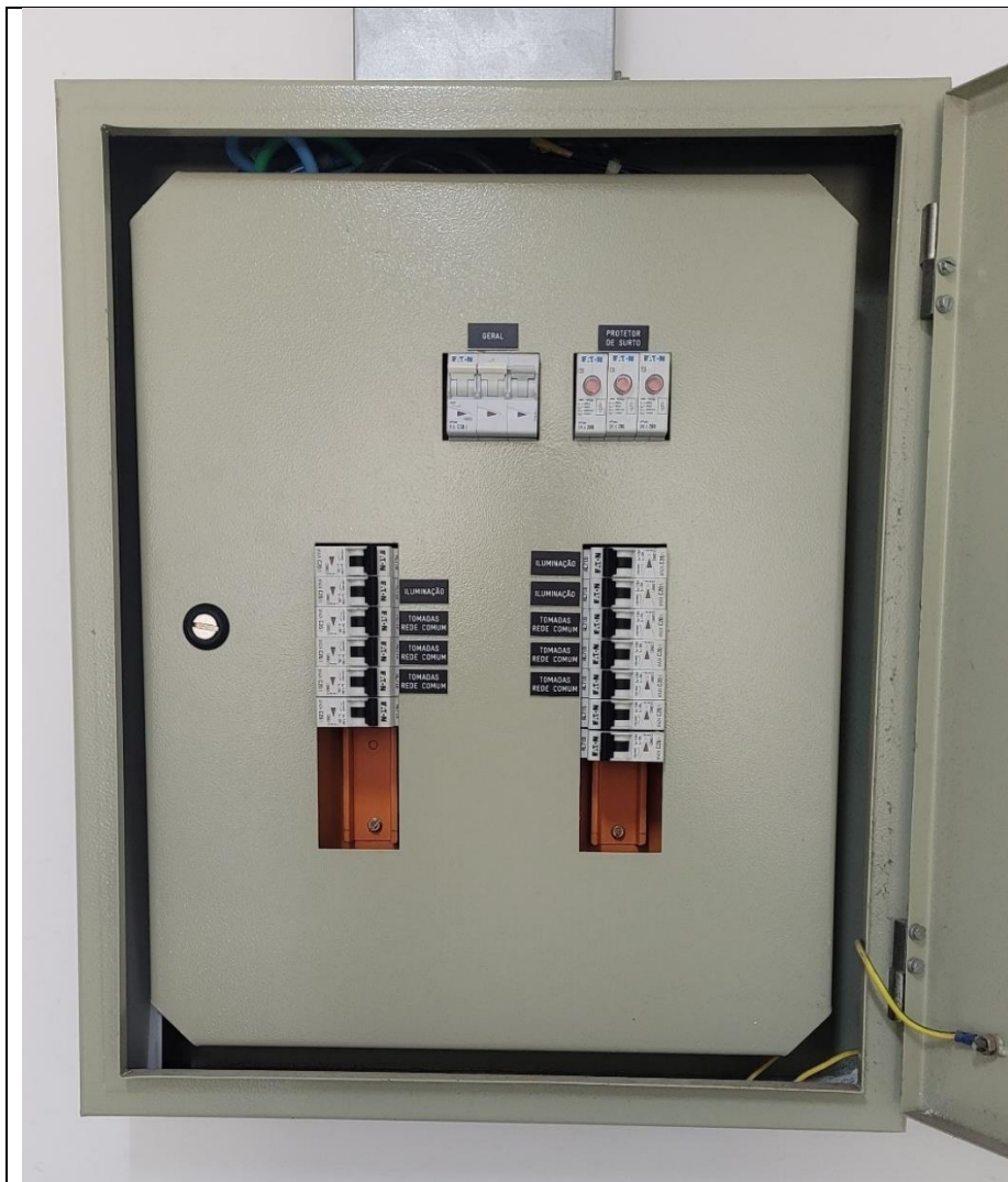
Fotografia 2 – Modelo de quadro de distribuição aberto
