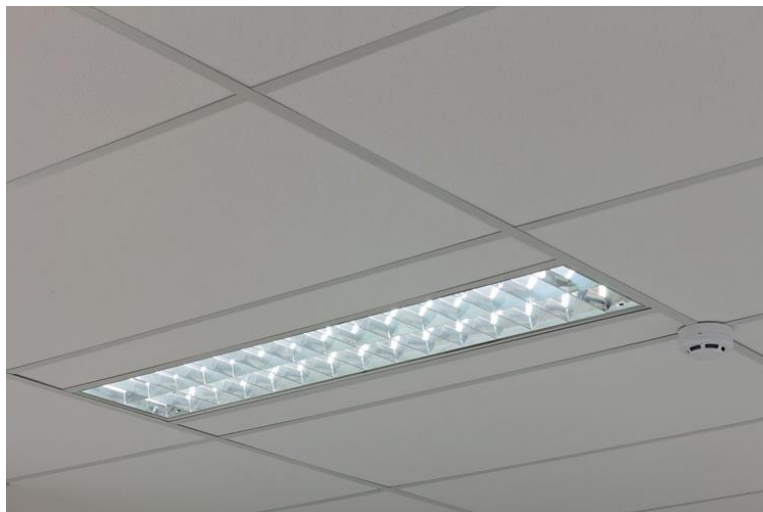
Figura 3 – Forro mineral modular termoacústico.
